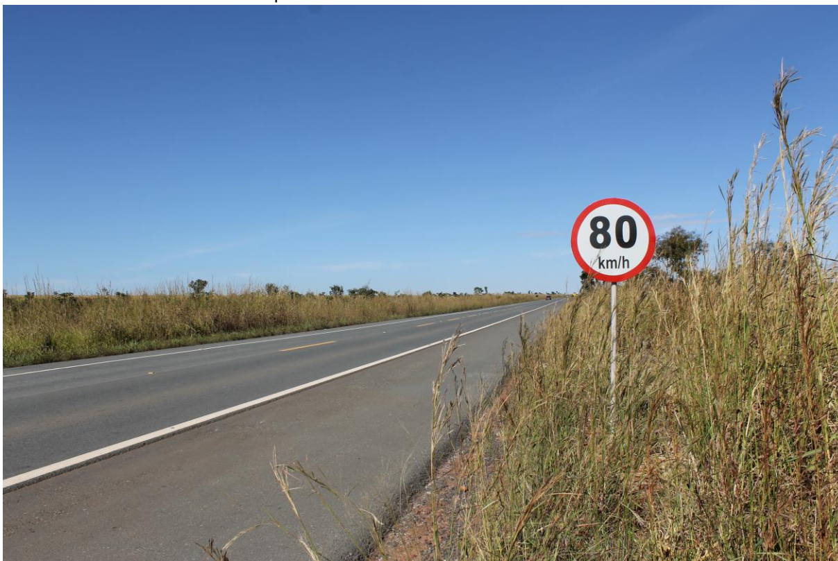
Figura 3 – Fotografia da DF-345 demonstrando a vegetação próxima aos acostamentos e a placa indicativa de velocidade máxima permitida de 80 km/h.
