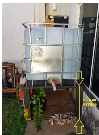
Figura 25 – Parte frontal do reservatório
