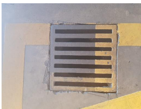
Figura 1 - Bueiro com grade
