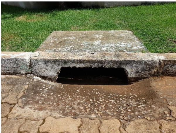
Figura 2 – Bueiro sem grade
