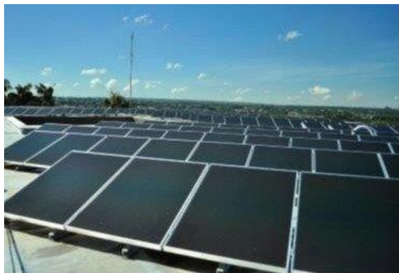
Figura 4: Sistema fotovoltaico no telhado da Embaixada.
