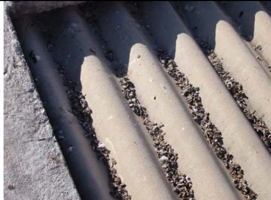
Fig 4.A Fezes acumuladas no telhado
