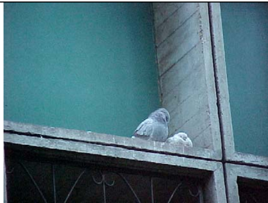
Fig 2.A Pombos abrigados na marquise do prédio
