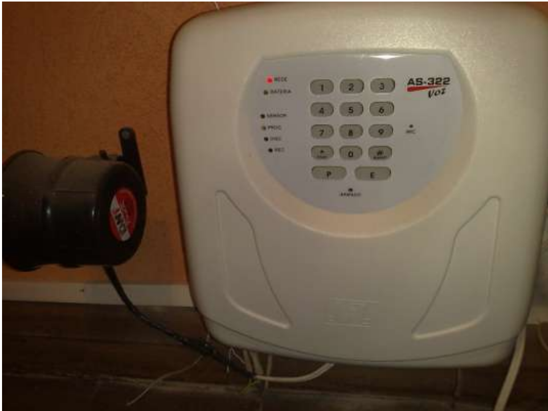
Imagem 3.1 – Central de Alarme
