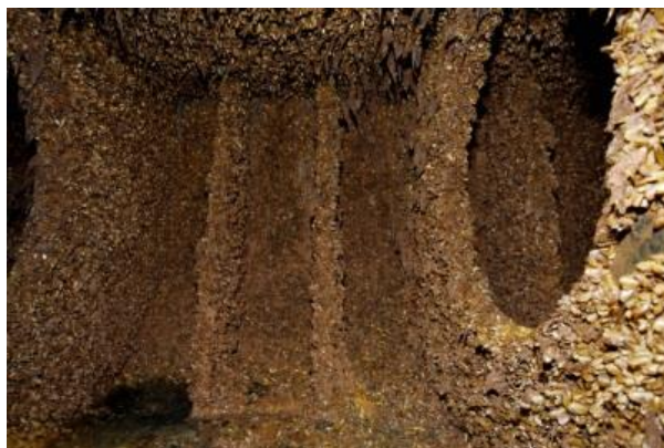
Figura 7 - Mexilhões dourados se proliferam em estruturas metálicas submersas da usina.
