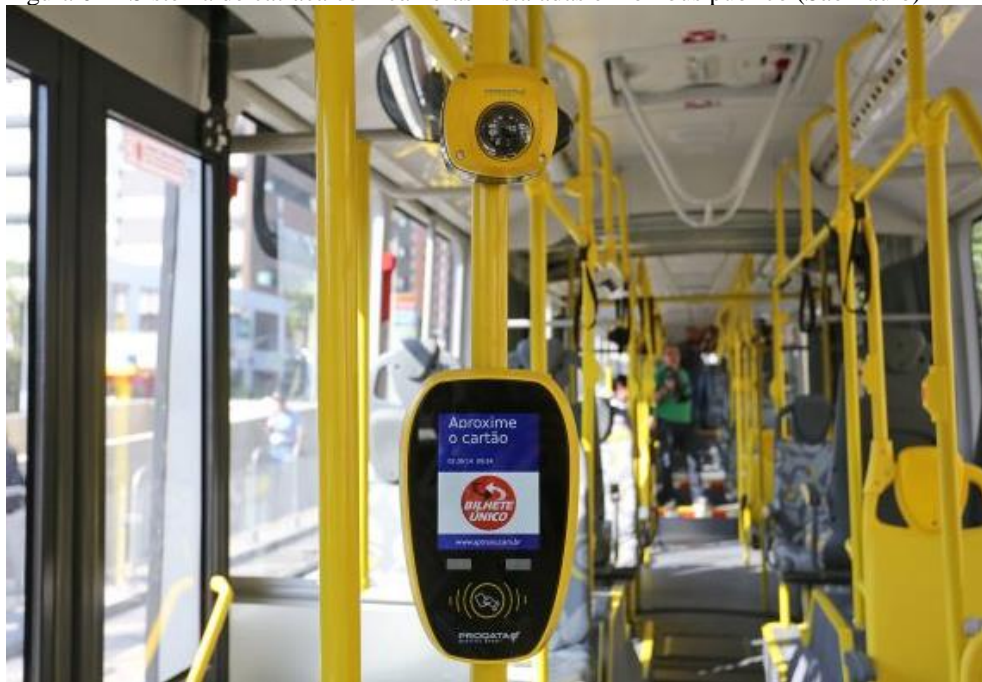
Figura 02 - Sistema de catraca com câmeras instaladas em ônibus público (São Paulo)
