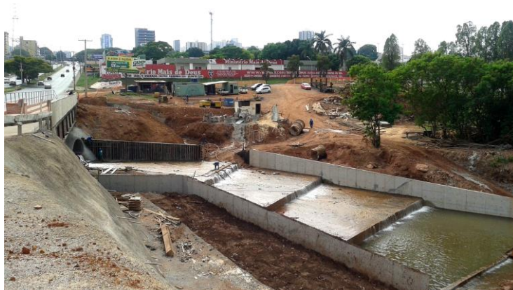
Figura 7: Obras de reparo de águas pluviais no Córrego Cortado. Via Elmo Serejo. Foto da autora
