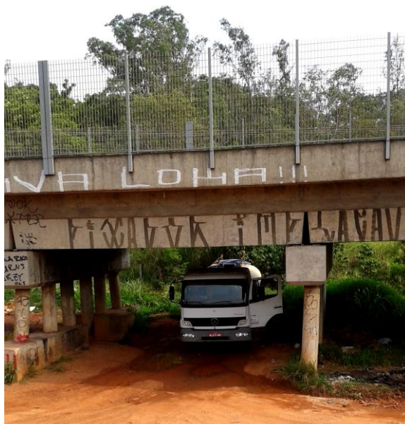
Figura 4: Caminhão pipa. Via Elmo Serejo. Foto da autora
