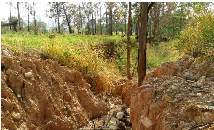
Figura 2: Erosão por água pluvial. Via Elmo Serejo. Foto da autora
