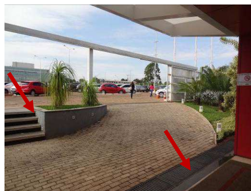
Figura 64: Rota S2, escada e rampa de acesso ao bloco 1, com cerca de 8% de inclinação, sem nenhum corrimão e com grelhas posicionadas de maneira desfavorável ao fluxo das pessoas. Fonte: Amanda Félix
