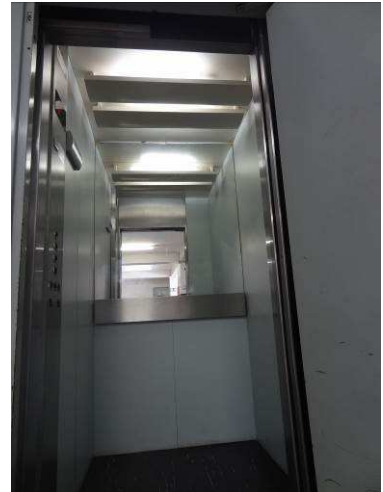
Figura 94: Cabina interna do elevador do bloco 8. Fonte: Amanda Félix
