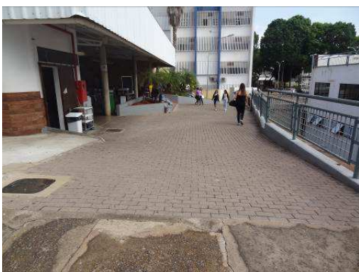
Figura 53: Rota S2, circulação interna do campus, rampa com cerca de 8% de inclinação sem corrimãos acessíveis, falta sinalização direcional tátil e visual e pequenos desníveis no piso. Fonte: Amanda Félix
