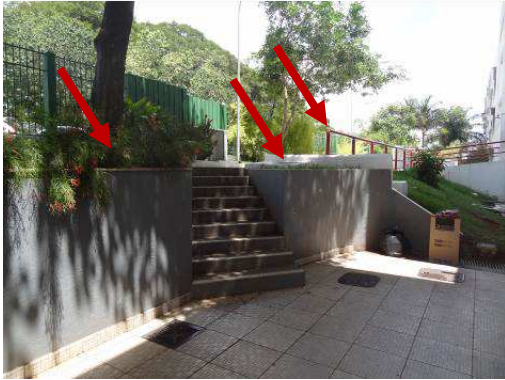
Figura 57: Rota P1B, trechos inclinados sem guarda-copo, escada sem corrimão e sinalização e guarda-corpo fora da norma. Fonte: Amanda Félix
