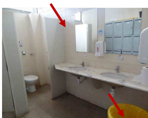
Figura 113: Banheiro feminino da sala dos professores do bloco 7. Detalhe do lixo como obstáculo e do espelho.
