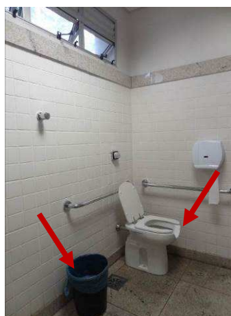
Figura 109: Banheiro feminino do bloco 1. Destaque para a lixeira mal posicionada e para o vaso sanitário aberto, que não é indicado para a acessibilidade.
