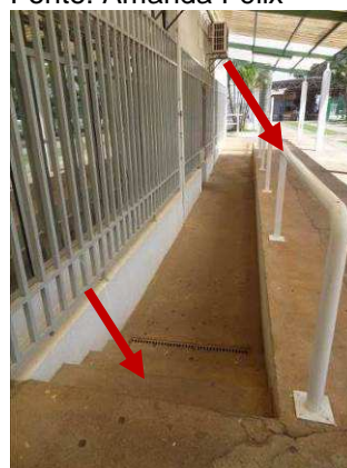
Figura 70: Rota P1D, Acesso posterior ao bloco 7, com escadas e rampa acessível, mas com corrimãos em desacordo e sem sinalização. Fonte: Amanda Félix
