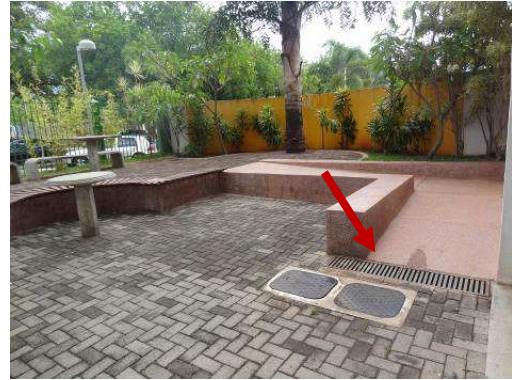
Figura 58: Rota P1, rampa sem corrimão e grelha posicionada de maneira desfavorável ao fluxo de acesso. Fonte: Amanda Félix
