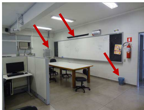
Figura 125: Bloco 8, ateliê 7, sala 8205. Destaque para o interruptor dos equipamentos e o telão fora da altura de alcance e para a lixeira como obstáculo na circulação. Fonte: Amanda Félix
