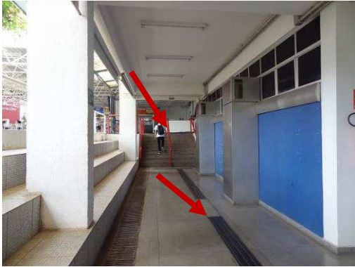
Figura 71: Rota P1, acesso posterior ao bloco 8, com escadas em ambos os lados. Uma poderia ser transformada numa rampa acessível. Detalhe da falta de um trecho da sinalização direcional. Fonte: Amanda Félix
