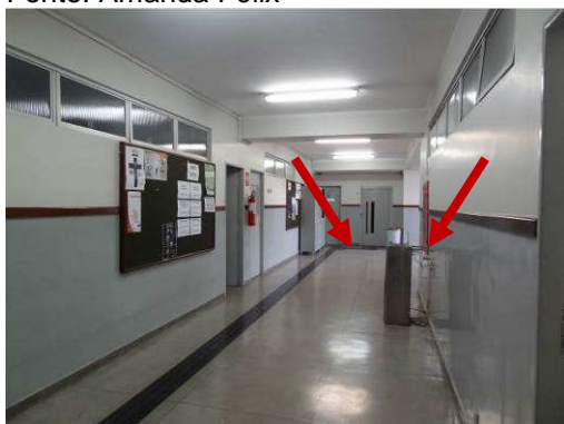
Figura 90: Rota de acesso interna do bloco 8, segundo pavimento. Destaque para o percurso da sinalização da rota acessível apenas até o banheiro e elevador, para os armários que bloqueiam a rota e para o bebedouro inacessível para cadeirantes.
