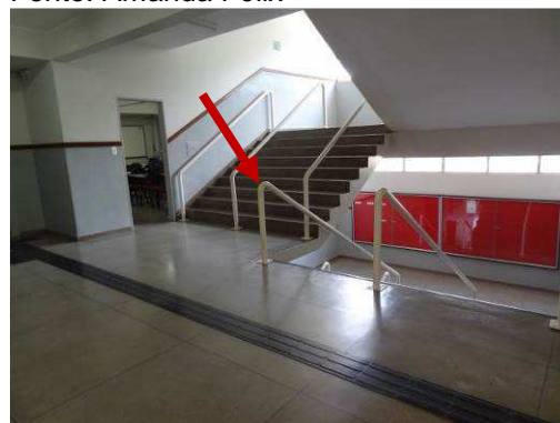
Figura 89: Rota de acesso interna do bloco 8, primeiro pavimento. Destaque para o percurso da sinalização da rota acessível até o elevador e para o corrimão da escada que está fora do padrão acessível. As escadas têm espelhos e degraus dentro da norma. Não há locais previstos para refúgio no caso de alguma emergência.
