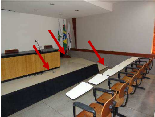
Figura 134: Auditório. Destaque para a rampa de acesso ao palco, sem corrimão, para as bandeiras posicionadas no final da rampa e para os fios soltos no palco. Fonte: Amanda Félix
