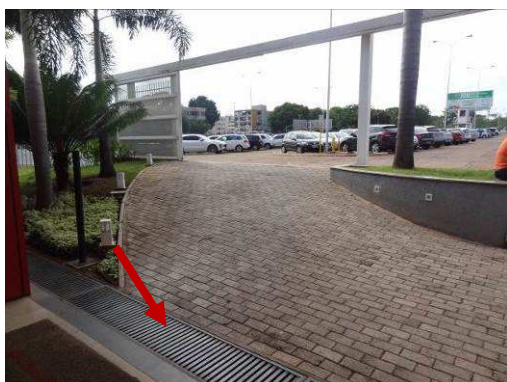
Figura 63: Rota S2, rampa de acesso ao bloco 1, com cerca de 8% de inclinação, sem nenhum corrimão e com grelhas posicionadas de maneira desfavorável ao fluxo das pessoas. Fonte: Amanda Félix
