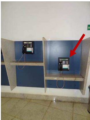
Figura 77: Cabinas telefônicas em acordo com a acessibilidade. Não há telefone que transmita mensagens de texto (TDD) e nem com amplificador
