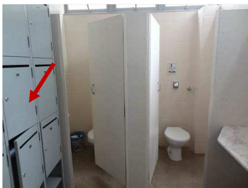
Figura 112: Banheiro feminino da sala dos professores do bloco 7. Destaque do espaço reduzido pela presença dos armários, que também impedem a abertura total da porta de acesso ao banheiro, ficando com um vão livre de cerca de 65cm.
