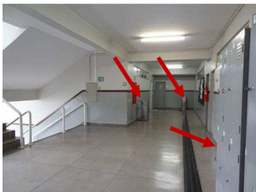
Figura 88: Rota de acesso interna do bloco 8, primeiro pavimento. Destaque para o percurso da sinalização da rota acessível até o banheiro e um dos bebedouros, que são inacessíveis para cadeirantes, não chegando até nenhuma sala de aula, para o corrimão da escada que está fora do padrão acessível e para os armários que bloqueiam a rota.
