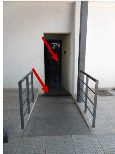
Figura 68: Rota P1B, acesso dos ateliês do pavimento térreo do bloco 4, acessível, mas com corrimãos em desacordo e sem sinalização. Destaque para a maçaneta de bolota e a grelha posicionada em sentido desfavorável ao fluxo. Fonte: Amanda Félix
