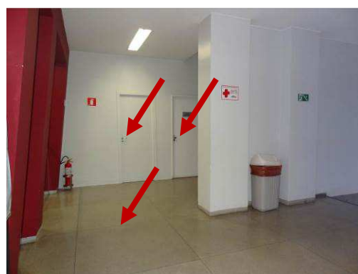
Figura 83: Circulação do pavimento térreo do bloco 7. Destaque para a ausência de sinalização direcional e para as portas, uma com maçaneta do tipo alavanca e outra do tipo bolota, que é inacessível para alguns. Fonte: Amanda Félix
