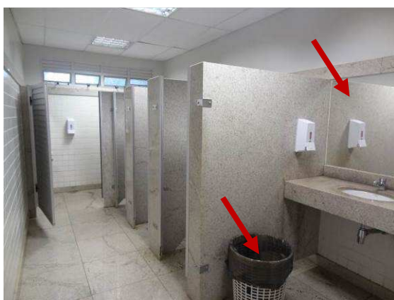
Figura 108: Banheiro feminino do bloco 1. Destaque para a lixeira mal posicionada e para o espelho.
