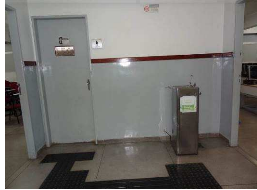
Figura 99: Bebedouro não acessível, localizado no primeiro pavimento. Fonte: Amanda Félix
