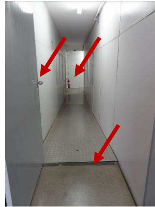
Figura 85: Corredor rampado de acesso às salas. Destaque para a porta com maçaneta do tipo bolota, que não é acessível, para saliência de cerca de 1cm no início da rampa e do extintor no final da rampa obstruindo um pouco a rota acessível.
