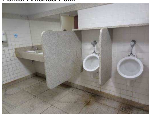
Figura 111: Banheiro masculino do bloco 1. Ausência de barras de apoio.
