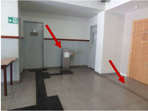
Figura 98: Bebedouro acessível no pavimento térreo do bloco 8. Destaque para a porta do auditório sem sinalização de piso. Fonte: Amanda Félix
