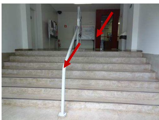
Figura 82: Escada de acesso ao pavimento térreo do bloco 7. Destaque para o corrimão inacessível, a ausência de sinalização direcional e os obstáculos na rota acessível, como as placas de informação do curso. Fonte: Amanda Félix
