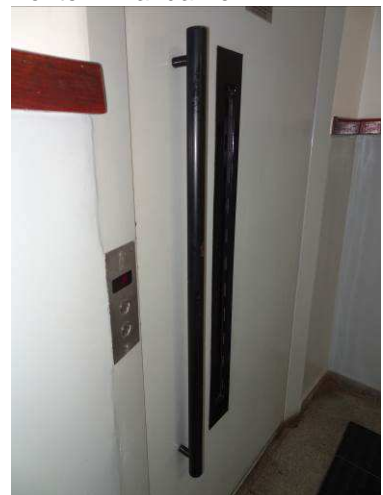
Figura 97: Cabina interna do elevador do bloco 8. Detalhe do sistema de abertura. Fonte: Amanda Félix
