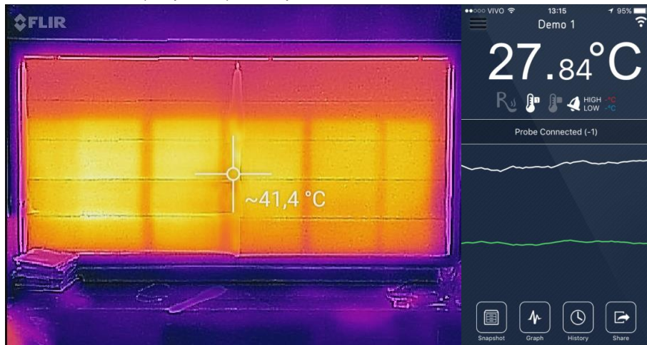
Figura 08- Foto térmica (esquerda) e temperatura do interior do cômodo às 13 horas.
