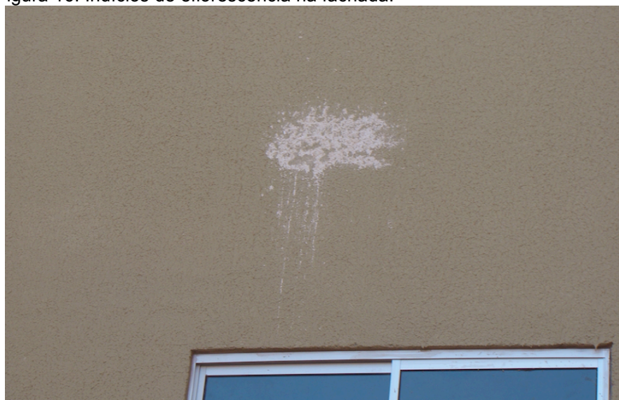
Figura 16: Indícios de eflorescência na fachada.
