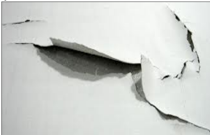
Figura 6: Demonstrativo de descascamento.
