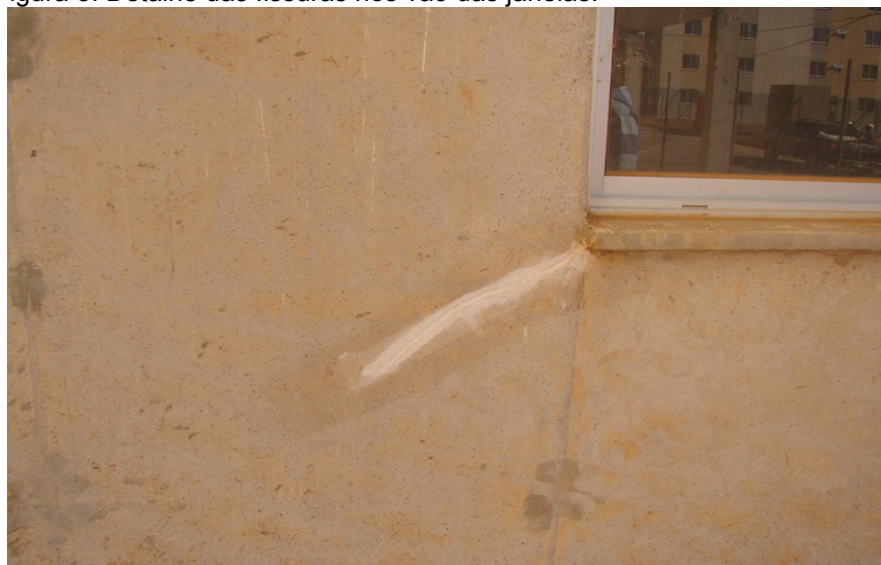
Figura 8: Detalhe das fissuras nos vão das janelas.
