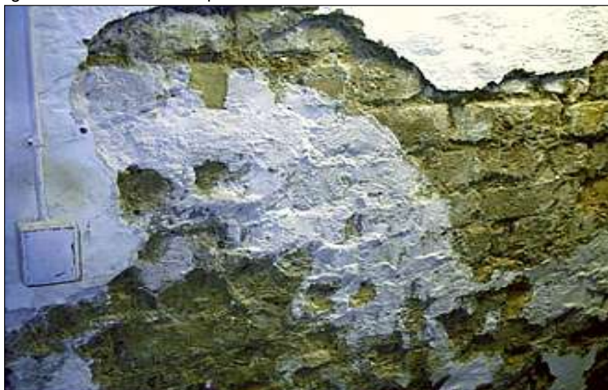
Figura 3: Demonstrativo típico de eflorescência.
