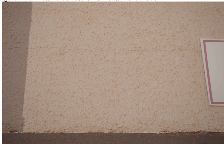
Figura 16.b: Detalhe de fissura horizontal na fachada.
