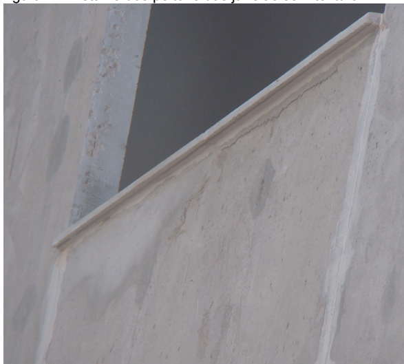
Figura 12: Detalhe dos peitoris das janelas sem textura.
