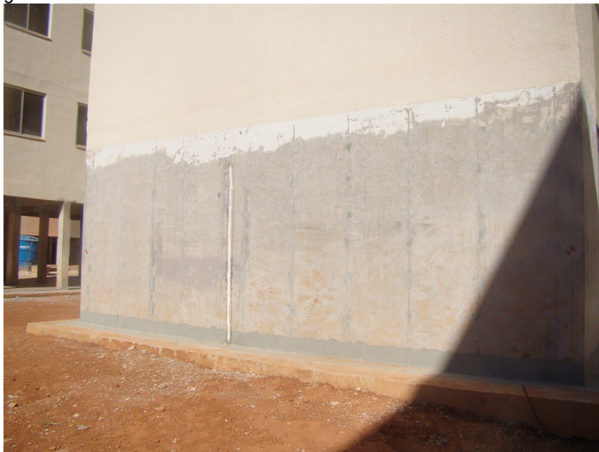
Figura 17: Detalhe de fissuras verticais na fachada.
