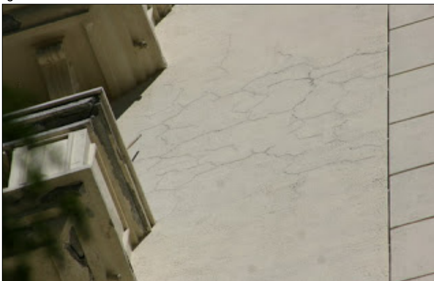
Figura 7: Demonstrativo de fissuras:
