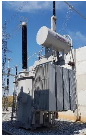
Figura 2.7 - Reator de linha (TOSHIBA) de 24,5 MVar da LT 500 kV Nova Iguaçu/Taubaté-C1 fase Azul no terminal de Nova Iguaçu - Rio de Janeiro
