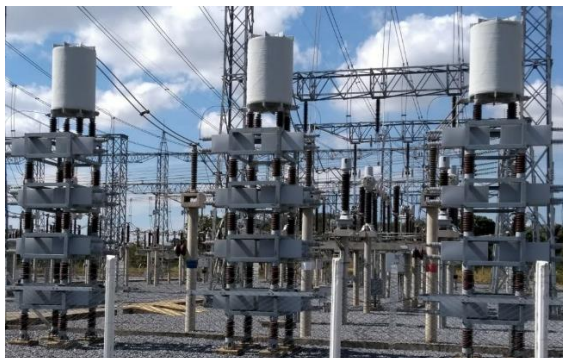
Figura 2.8 – Capacitores Shunt trifásicos (SIEMENS) de 24,5 MVar conectados a barra de 138 kV na Subestação de Sete Lagoas 04 – Minas Gerais
