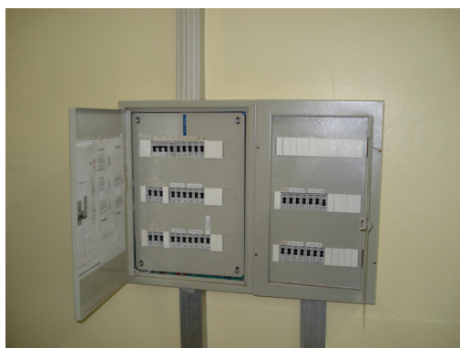
Imagem 33 - Quadro de distribuição
