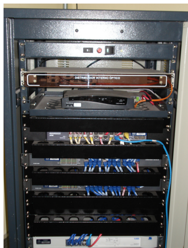
Imagem 31 - Rack principal do Laboratório (Vista interna)
