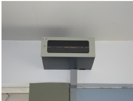
Imagem 35 - Rack do 3º andar (Corredor)
