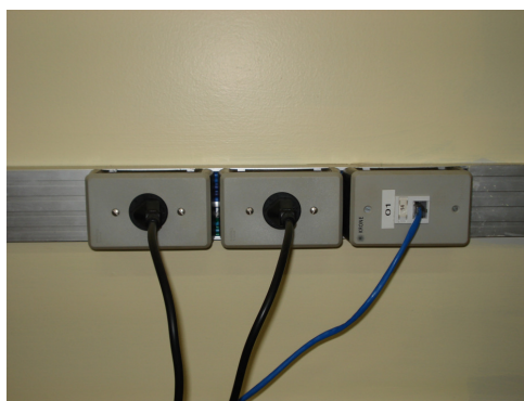
Imagem 32 - Tomada elétricas e lógica
