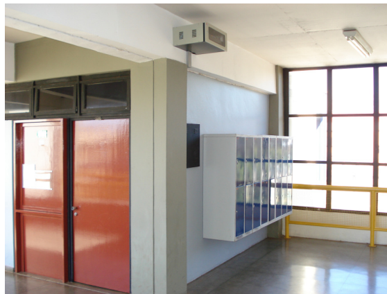
Imagem 36 - Rack do 3º andar (Outra)
