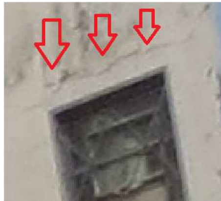
Figura 31 – Detalhe de manifestação patológica tipo 1 no edifício A
