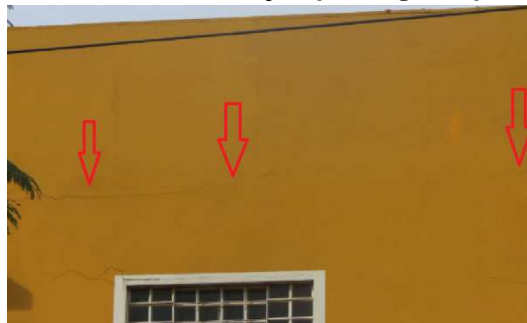
Figura 51 – Detalhe de manifestação patológica tipo 4 no edifício C
