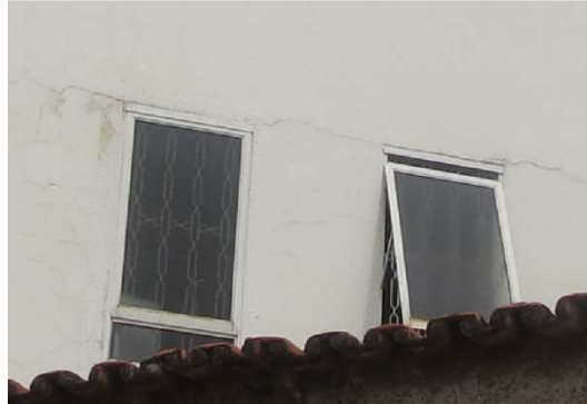
Figura 39 – Detalhe de manifestação patológica tipo 2 no edifício B
