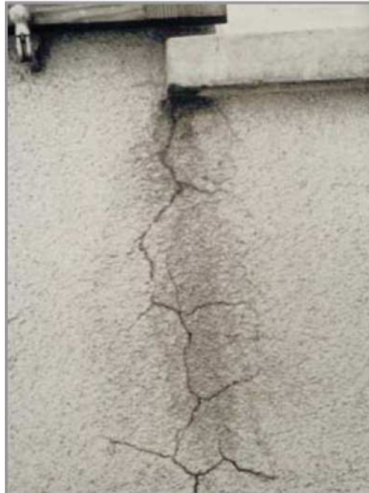
Figura 13 – O fluxo de água interceptado no peitoril escorre lateralmente
