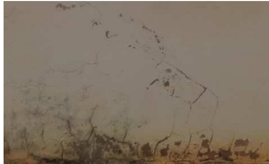
Figura 45– Detalhe de manifestação patológica tipo 5 no edifício B
