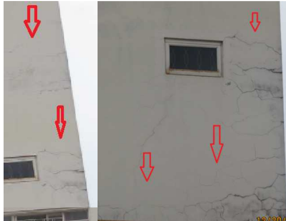
Figura 40– Detalhes de manifestação patológica tipo 3 no edifício B
