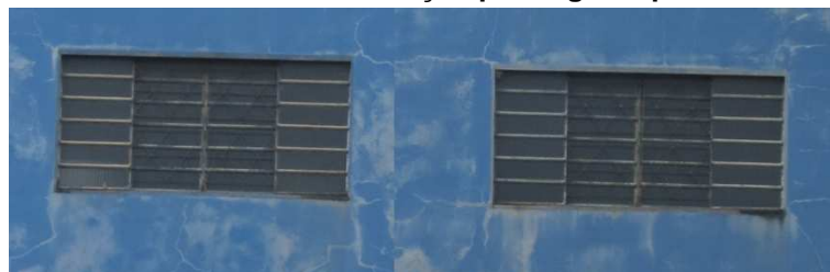
Figura 32 - Detalhes de manifestação patológica tipo 2 no edifício A
