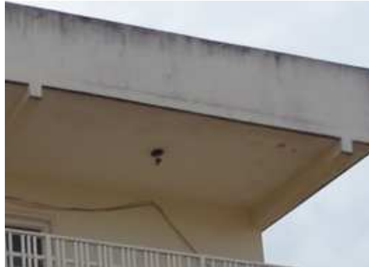
Figura 42 – Detalhe de manifestação patológica tipo 4 no edifício B
