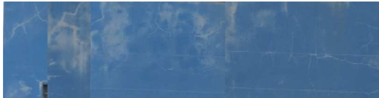
Figura 35 – Detalhes de manifestação patológica tipo 3 no edifício A
