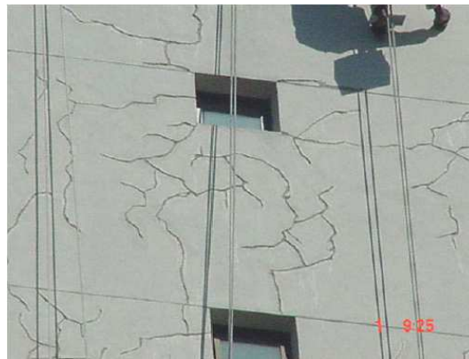
Figura 12 - Fissuração típica na argamassa por movimentação térmica
