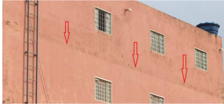
Figura 59 – Detalhe de manifestação patológica tipo 4 no edifício D
