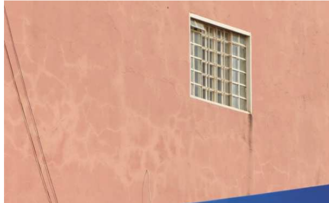
Figura 56 – Detalhe de manifestação patológica tipo 3 no edifício D
