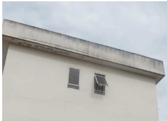
Figura 43 – Detalhe de manifestação patológica tipo 4 no edifício B
