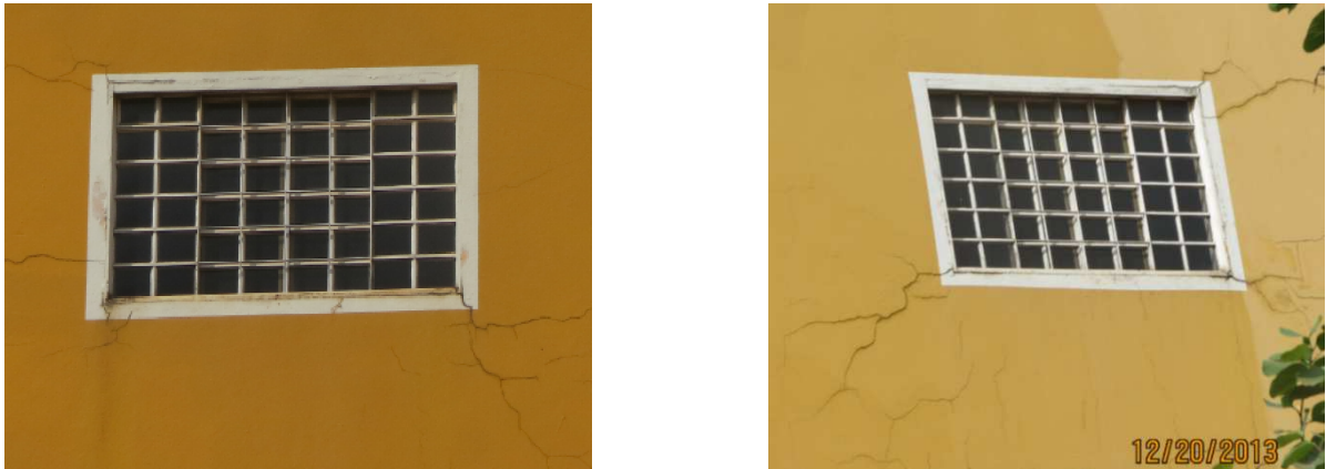
Figura 49 – Detalhes de manifestação patológica tipo 2 no edifício C
