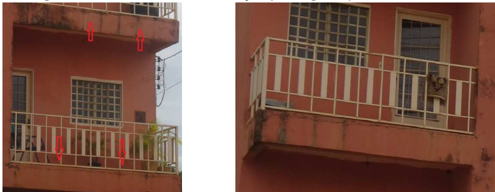
Figura 58 – Detalhes de manifestação patológica tipo 4 no edifício D
