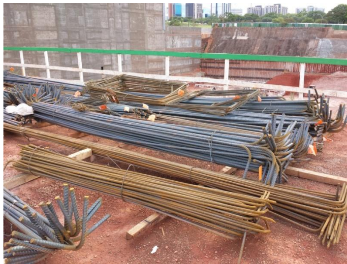
Figura 10 – Armaduras de aço estocadas no canteiro de obras do empreendimento Green Towers , localizado em Brasília-DF.
