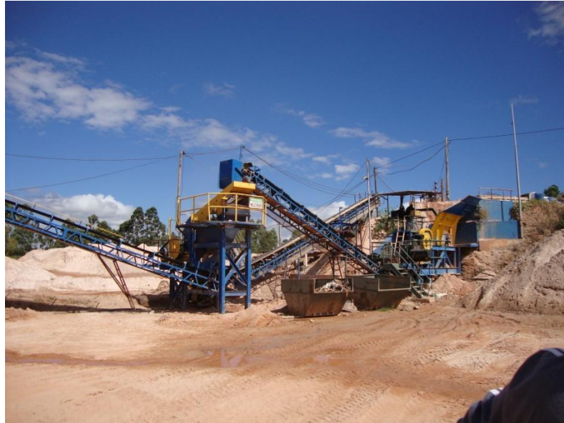
Figura 16 – Maquinário utilizado para britagem de RCD Classe A, na empresa Areal Bela Vista, Brasília-DF.
