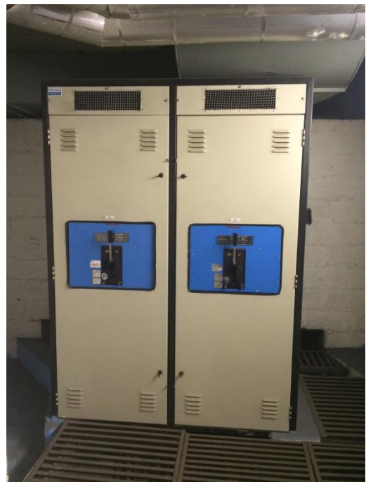
Figura 22 - Quadro de entrada de energia CEB - BT
