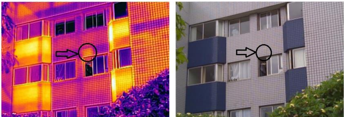
Figura 12 - Descolamento de revestimento cerâmico
