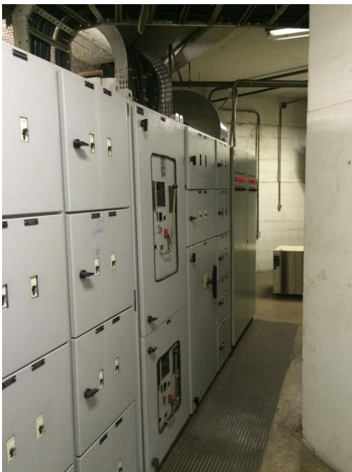
Figura 21 - Quadro de Distribuição BT
