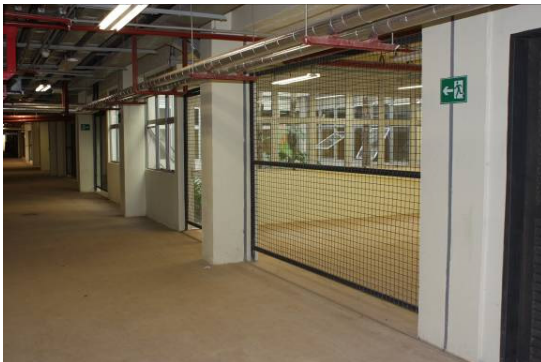
Figura 55: Arquitetura, tubulações de diversas instalações e estrutura no subsolo ou em galeria
