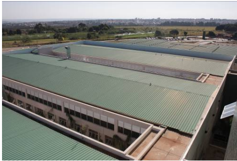
Figura 66: Duto de exaustão na cobertura do HSMA - SES DF
