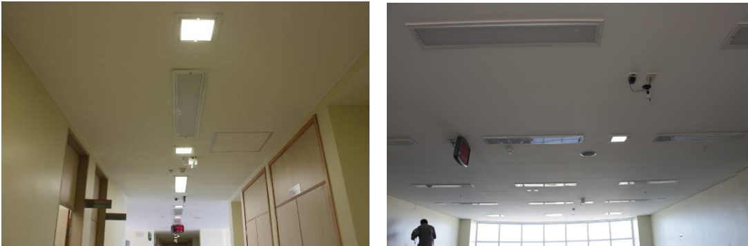
Figura 54: Instalações diversas instaladas na circulação central, no teto
