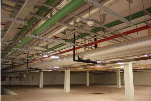
Figura 50: Subsola com rede de ar condicionado do Hospital de Santa Maria – SES DF
