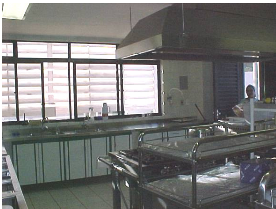
Figura 62: Cozinha do Hospital da UNIMED - DF
