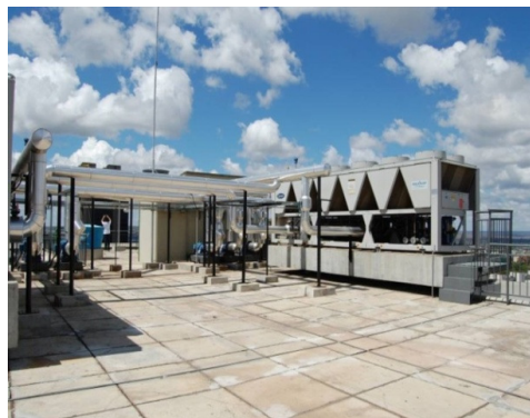
Figura 34: Central do sistema de ar condicionado na cobertura no HBDF - SES DF (a ar)
