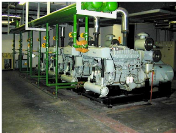
Figura 24: Andar técnico do Hospital Sírio e Libanês – SP
