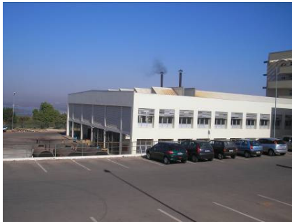
Figura 67: Exaustão na cobertura do HRP A - SES DF
