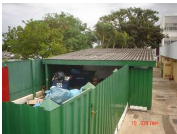
Figura 4 – Cobertura de amianto
