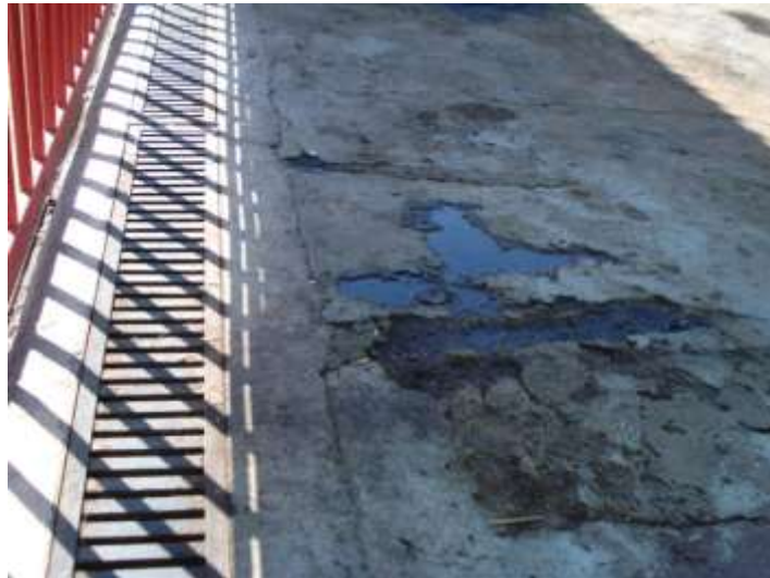
Figura 5 – Piso danificado e grelha de captação de águas pluviais
