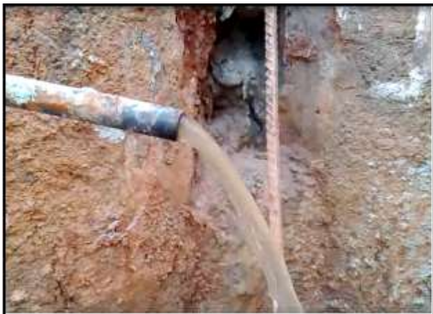
Figura 5. Água que percola pelo furo dos tirantes
