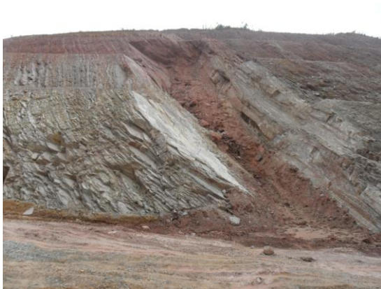
Figura 7. Ruptura no talude do Corte 119.
