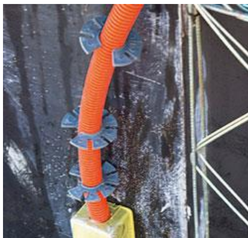
Figura 9 – Espaçadores nas tubulações
