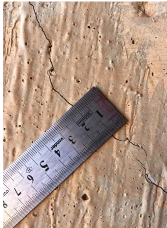
Figura 4-20 Medição de fissura (1)
