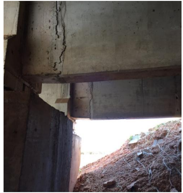
Figura 4-18 Efeitos de recalque do lado direito
