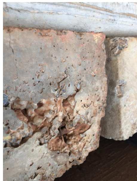
Figura 4-30 Segregação próximo ao apoio
