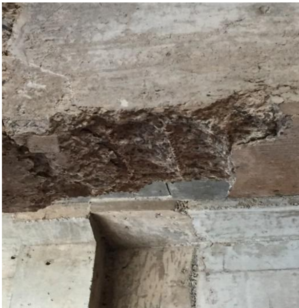
Figura 4-3 Desagregação na viga 004
