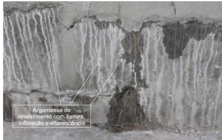
Figura 2-12 Infiltração em parede
