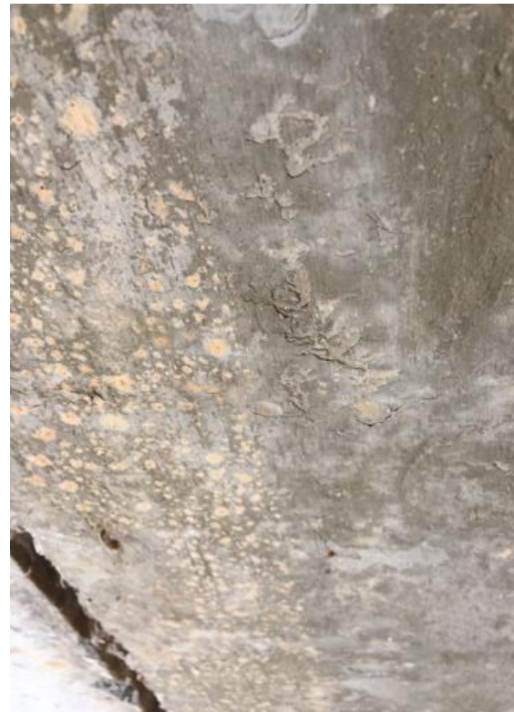
Figura 4-12 Manchas na laje 1
