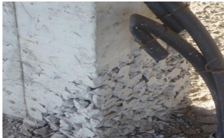
Figura 2-2 Segregação na base de um pilar
