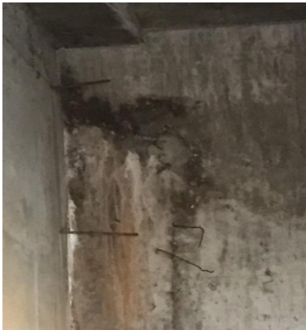
Figura 4-7 Infiltração na viga 010
