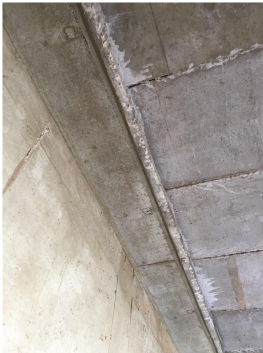
Figura 4-45 Sinais de Eflorescência
