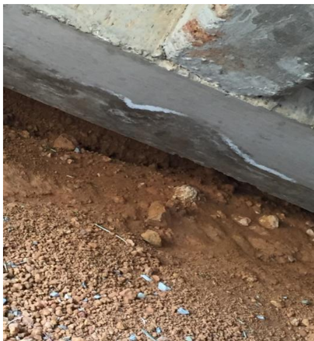
Figura 4-8 Eflorescência na viga 009
