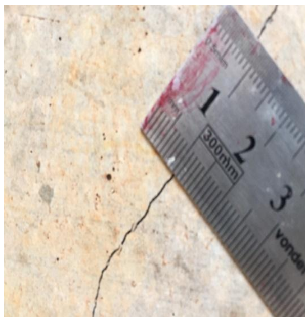
Figura 4-10 Fissura na viga 007
