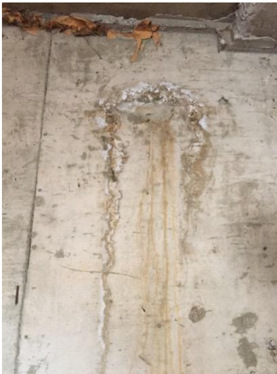
Figura 4-19 Eflorescência na viga 009
