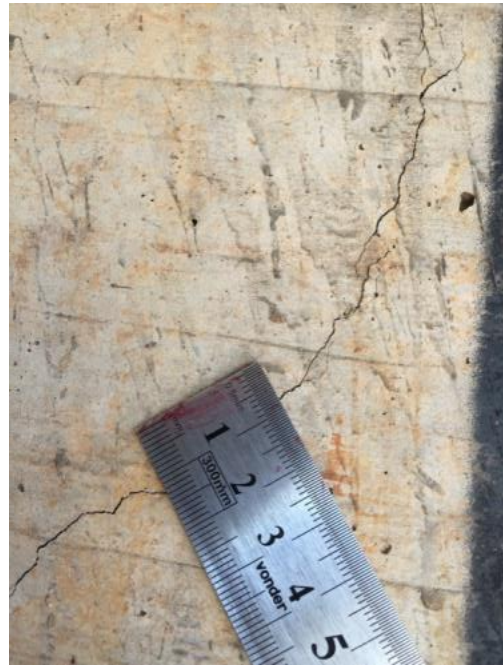
Figura 4-22 Medição de fissura (3)
