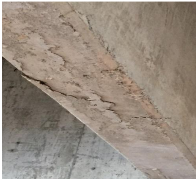
Figura 4-6 Deslocamento na viga 005
