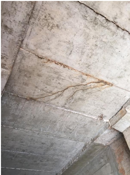
Figura 4-35 Carbonatação na laje
