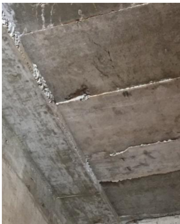
Figura 4-24 Falha de concretagem
