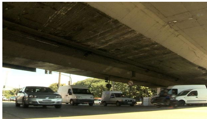
Figura 2-3 Mofos causados por infiltração
