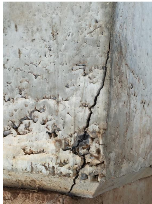
Figura 4-32 Fissura próximo ao apoio
