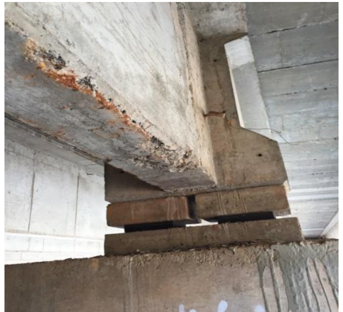
Figura 4-4 Desagregação na viga 002
