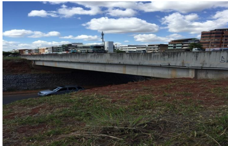
Figura 4-48 Manchas na barreira da OAE 4
