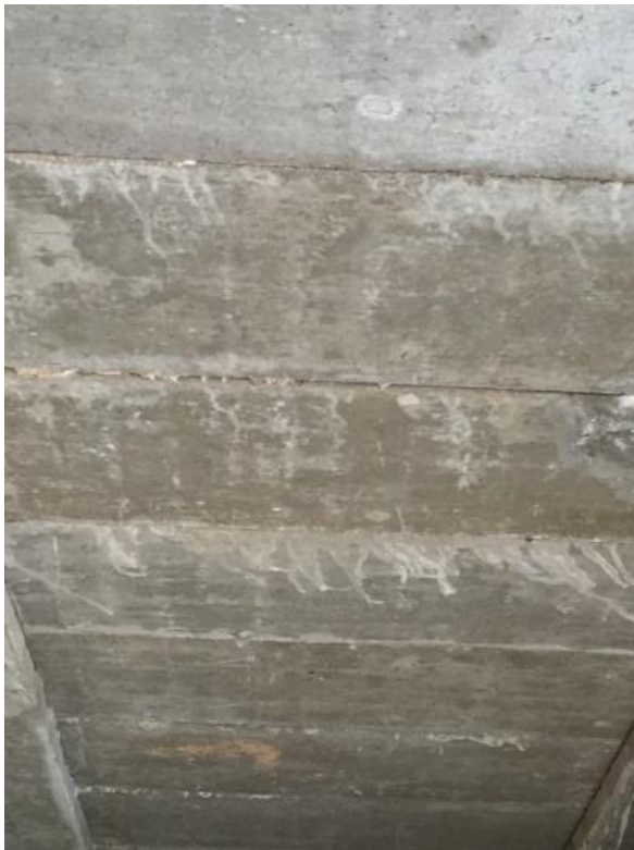
Figura 4-11 Eflorescência na laje 5
