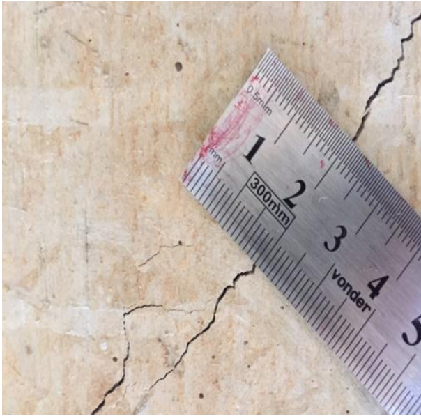
Figura 4-21 Medição de fissura (2)
