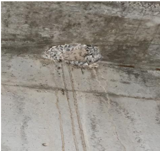
Figura 4-5 Falha de concretagem na viga 001
