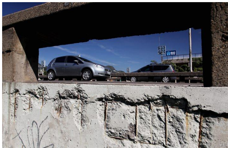
Figura 2-7 Reduzida espessura de cobertura da armadura em pilar
