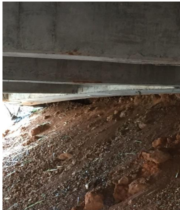
Figura 4-9 Flecha na viga 009
