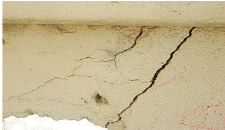
Figura 2-10 Fissura em peça de concreto
