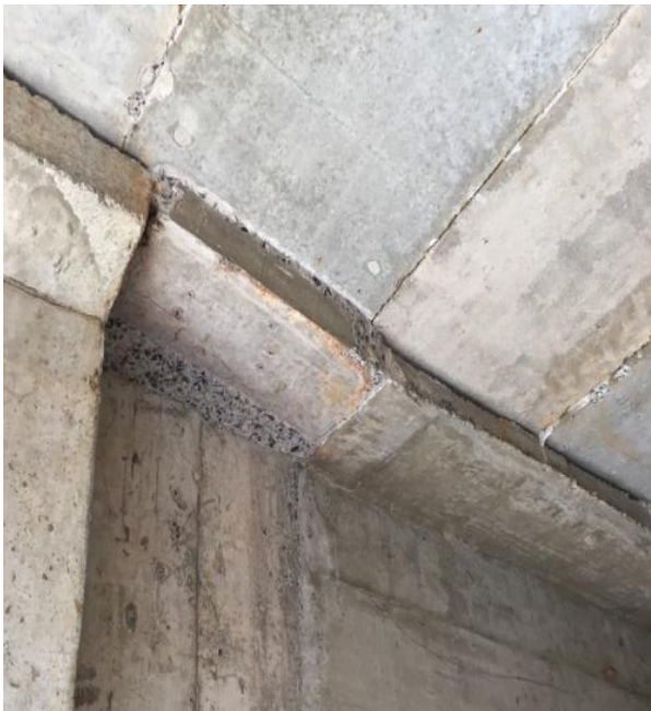
Figura 4-17 Efeitos de recalque no lado esquerdo
