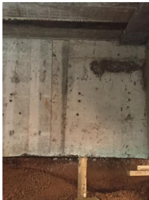
Figura 4-44 Manchas na viga 010
