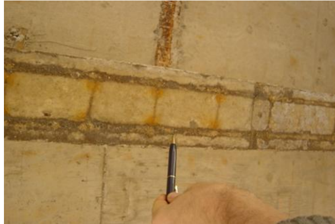
Figura 2-8 Manifestação patológica em alvenaria
