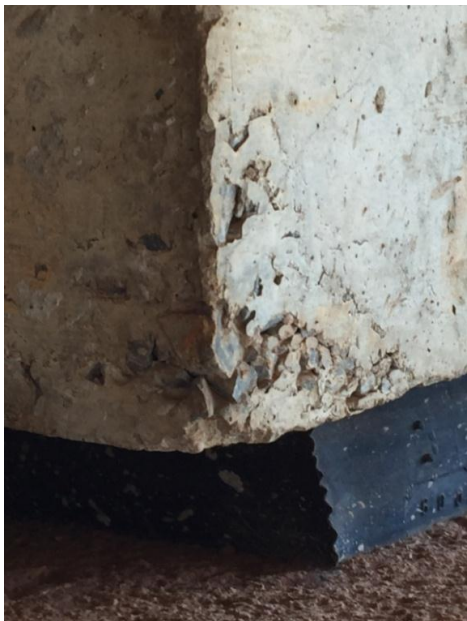
Figura 4-41 Cobrimento deficiente próximo ao Neoprene
