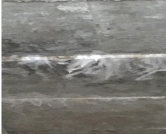
Figura 2-4 Eflorescência em laje
