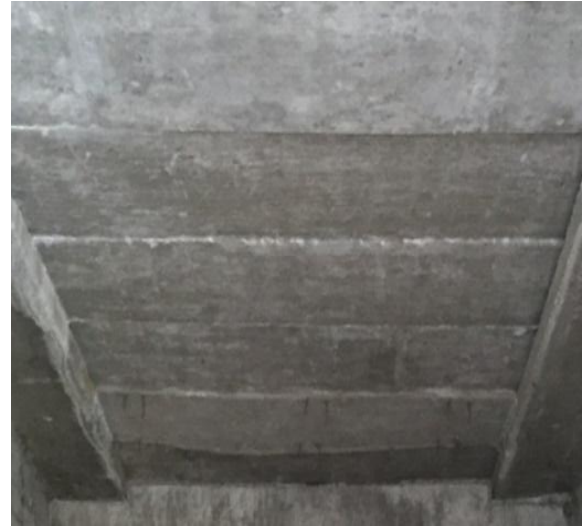
Figura 4-14 Flecha na laje próximo a viga principal
