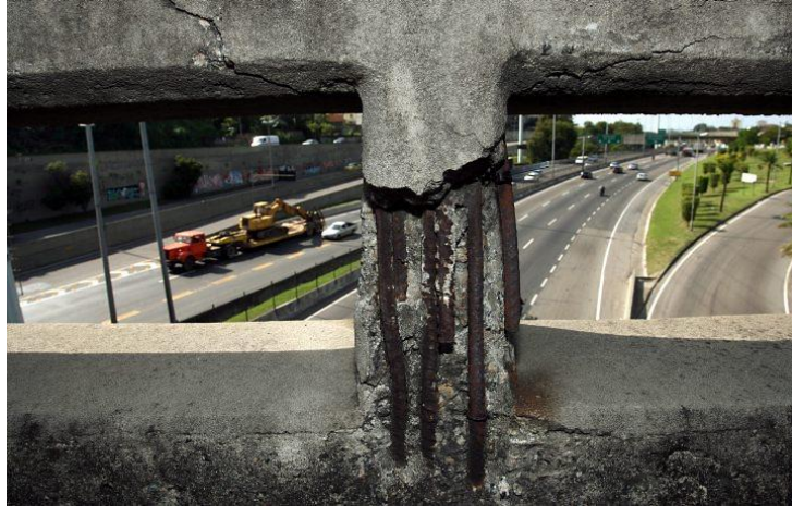
Figura 2-6 Perda de cobertura próximo a base de pilar
