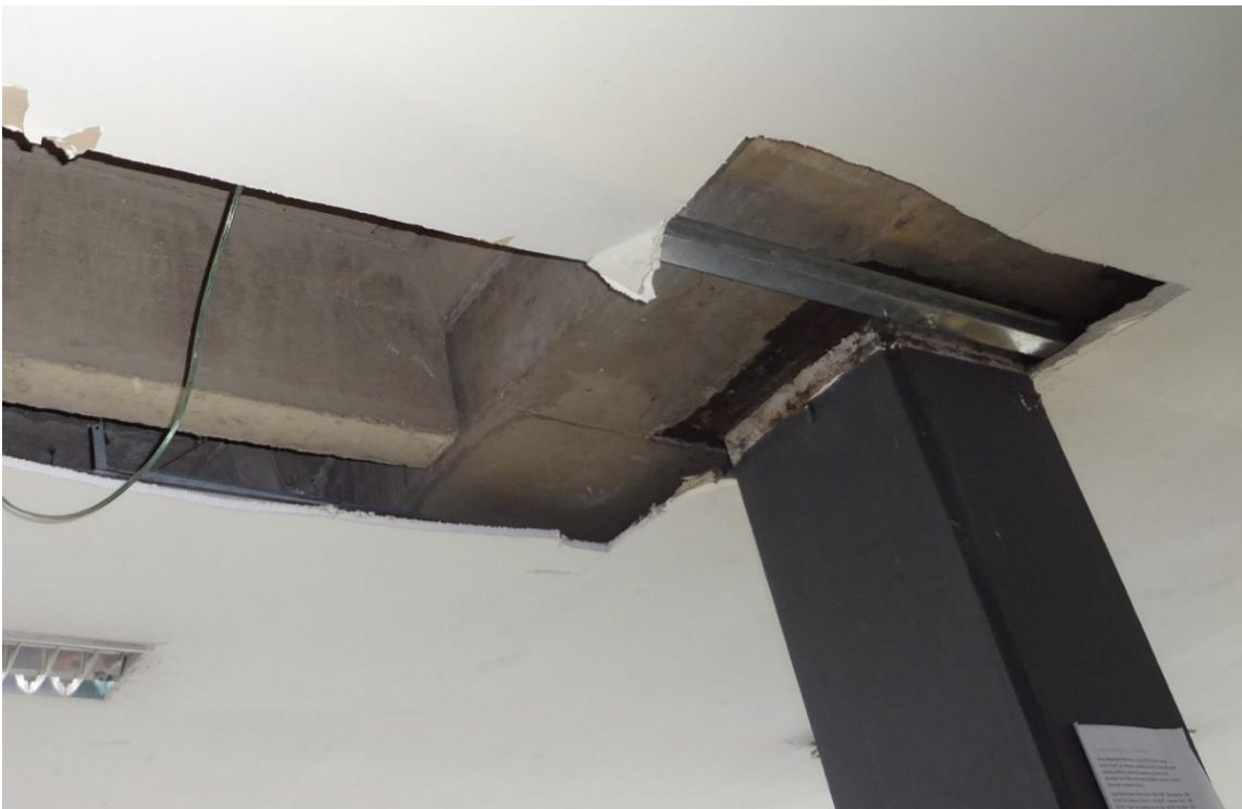
Imagem 13: Detalhe da ligação do Pilar metálico com a laje da Cobertura da Plataforma Superior da Rodoviária de Brasília
