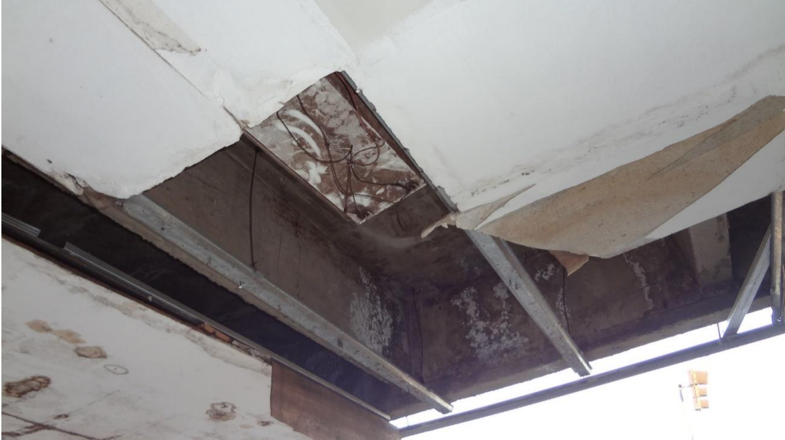
Imagem 14: Detalhe do forro destruído e da estrutura aparente
