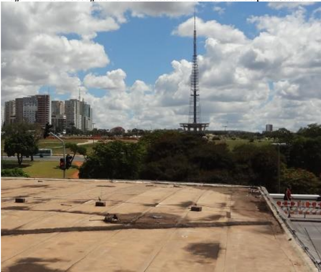
Imagem 11: Acúmulo de água em um dos vértices com maior deflexão no topo da Cobertura
