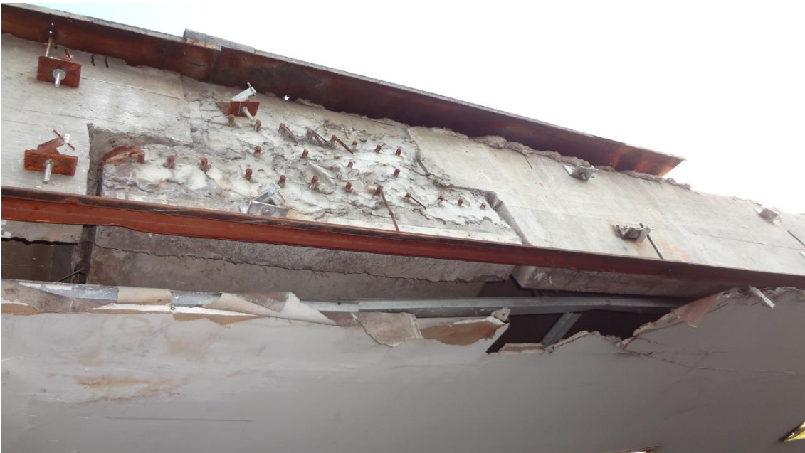
Imagem 15: Detalhe do dente Gerber com as armaduras expostas
