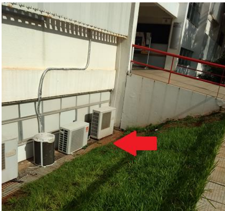
Figura 3.20 - Localização da passagem do cabo do subsistema de aterramento do Bloco Único
