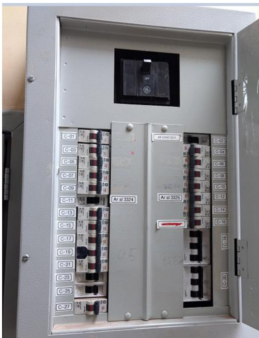
Figura 3.23 – Estado atual do quadro intermediário do bloco 3
