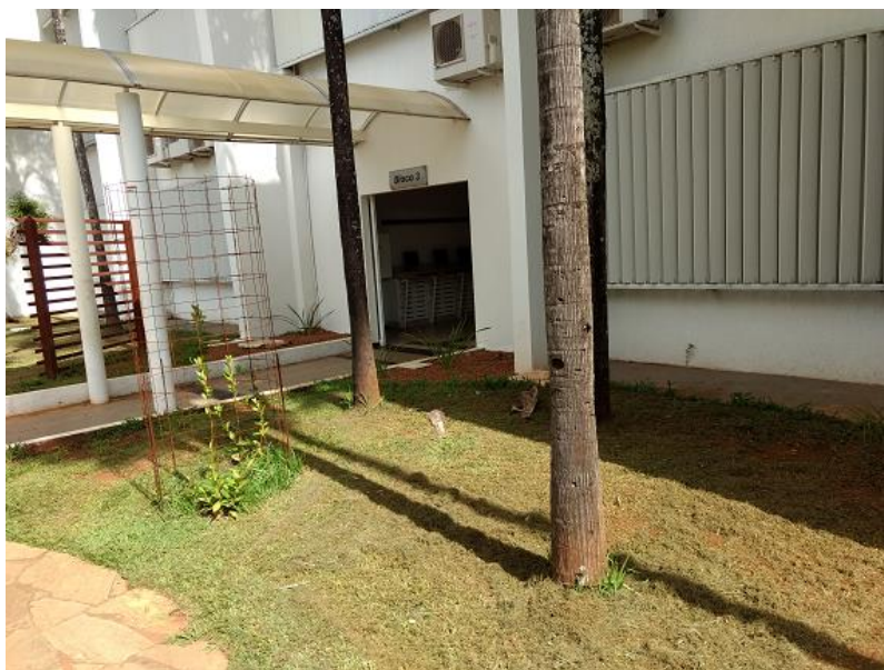
Figura 4.1 – Entrada que deve ser interditada com a instalação dos componentes do subsistema de aterramento do bloco 3
