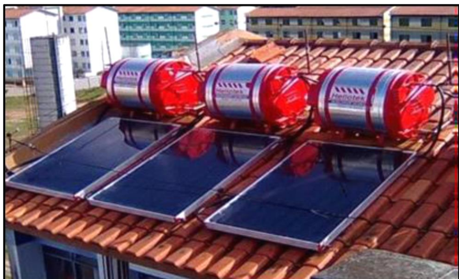
Figura 6: Sistema de Aquecimento Solar
