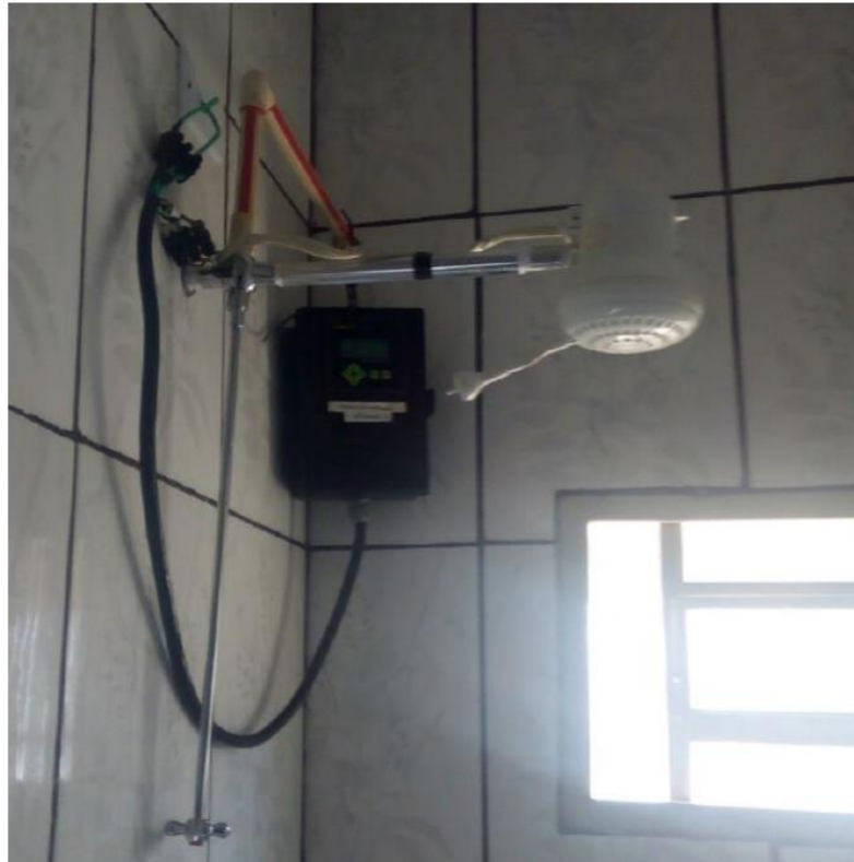
Figura 5: Sistema de medição instalado
