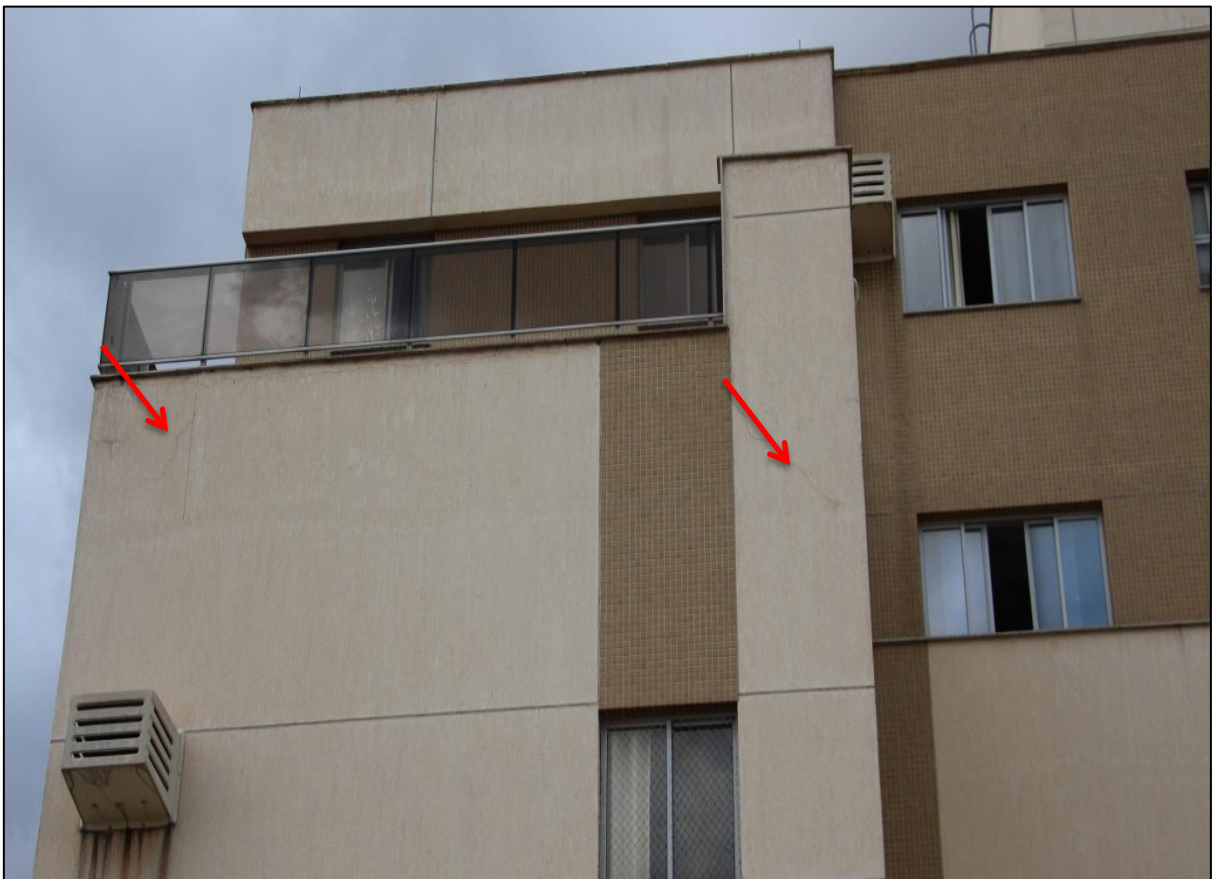
Figura 19 – Fissuras, Eflorescência E Depósito De Poluição Em Fachada Da Torre II
