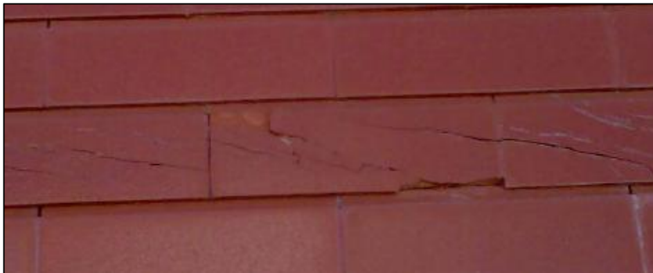
Figura 10 – Fissura No Revestimento Cerâmico
