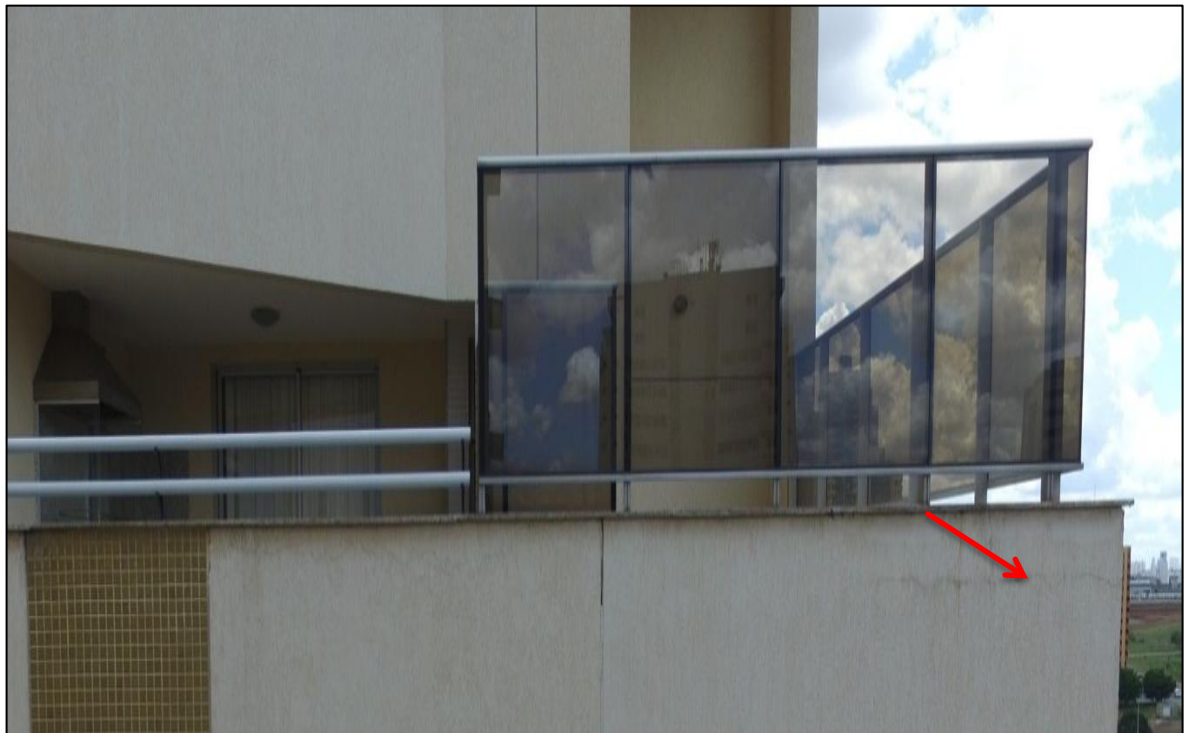
Figuras 17 – Fissuras Em Fachadas Da Torre II
