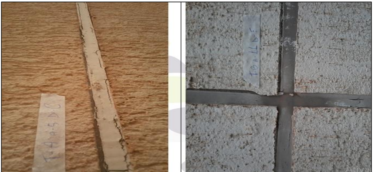
Figura 27 - Junta De Movimentação Com Falha Precoce – Torre A E B
