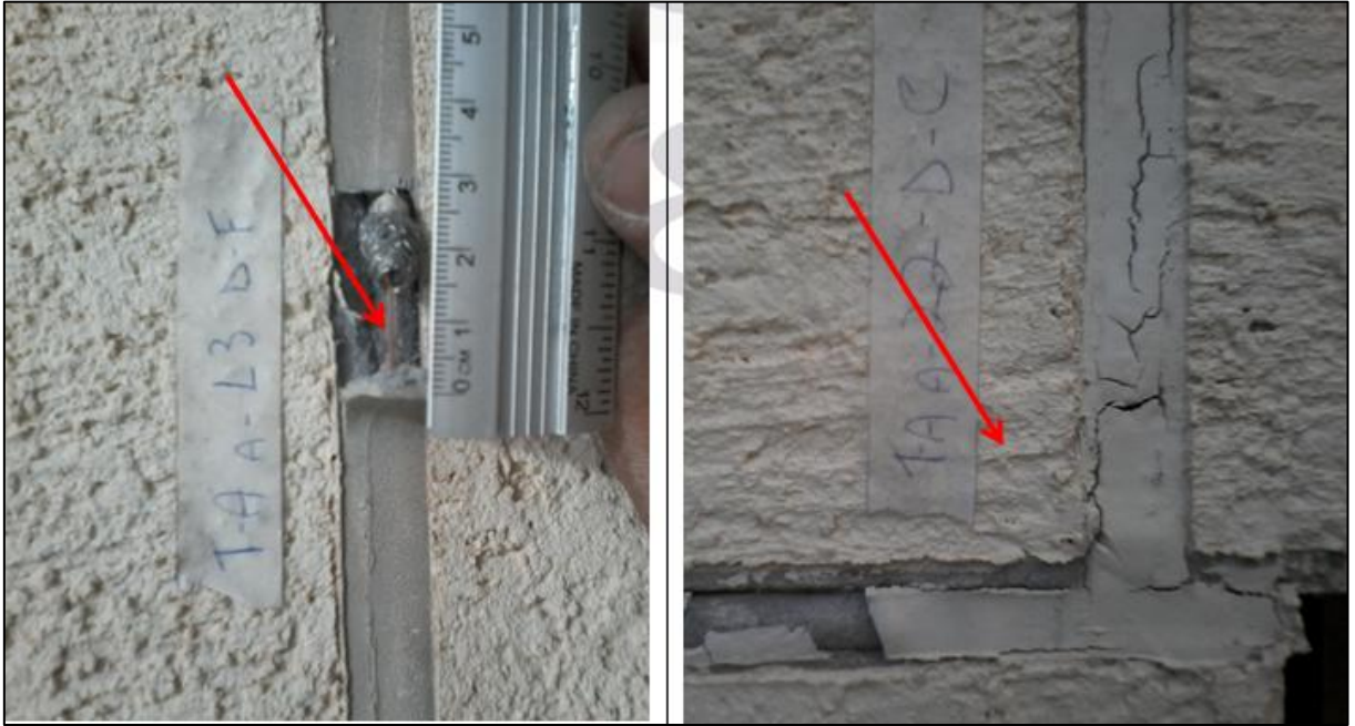
Figura 24 - Junta De Movimentação Executada Sem Adoção Do Fator De Forma Previsto Em Norma NBR 13755:1996 (Espessura Reduzida) – Torre A – 13° Descida F – 22° Andar – Descida C
