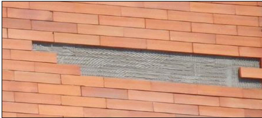
Figura 9 – Descolamento Do Revestimento Cerâmico
