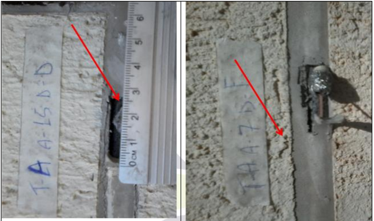
Figura 25 – Junta De Movimentação Executada Sem Adoção Do Fator De Forma Previsto Em Norma NBR 13755:1996 (Espessura Reduzida) – Torre A – 15° Descida D – 22° Andar – Descida C
