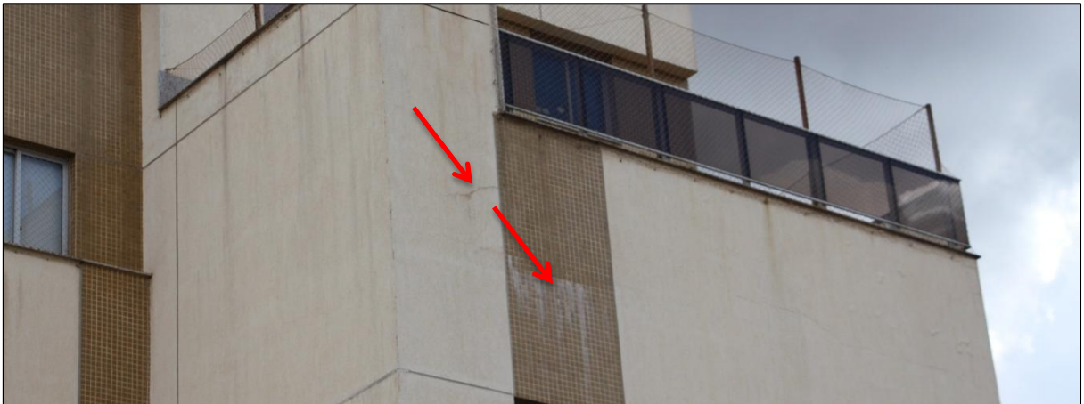
Figura 20 – Eflorescência E Depósito De Poluição Em Fachada Da Torre I
