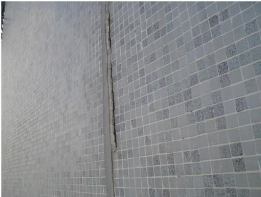
Figura 7 - Falhas nas Juntas de Dilatação.
