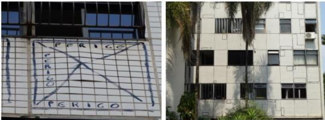
Figura 18- Identificação das áreas comprometidas.
