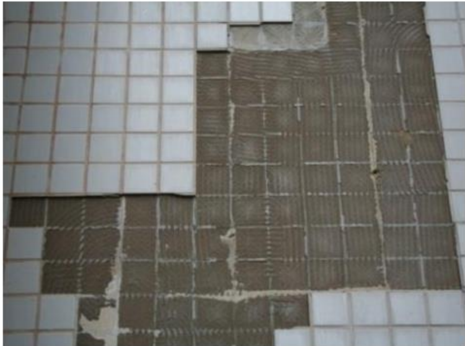
Figura 6 - Deslocamento de cerâmica.
