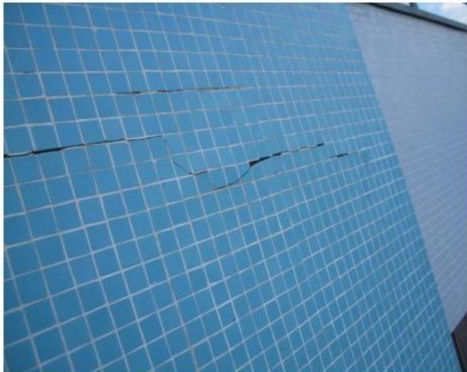
Figura 4 - Fissura na fachada de revestimento cerâmico.
