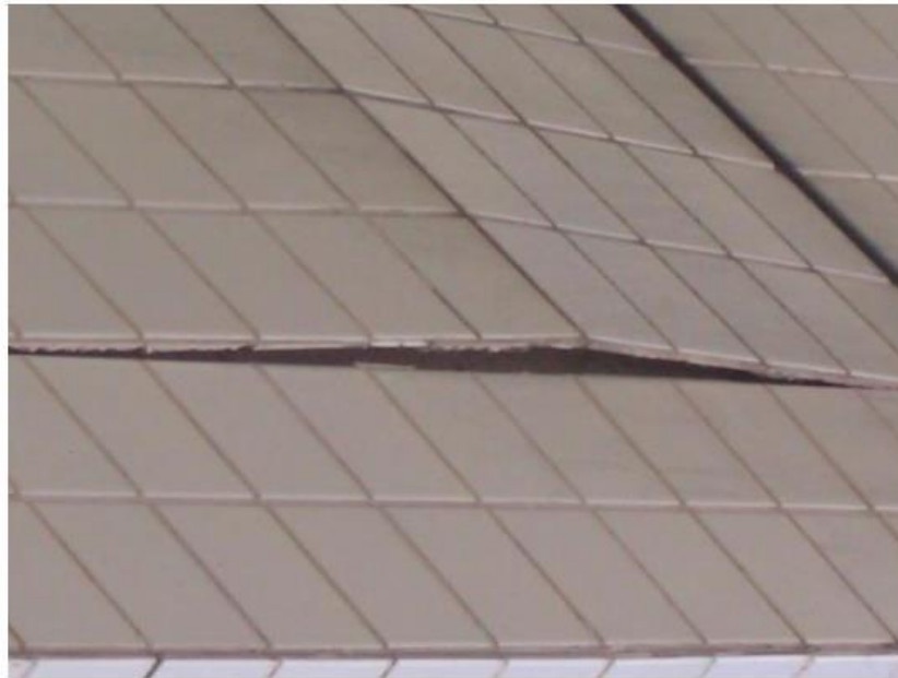
Figura 5 - Descolamento de placas cerâmicas.
