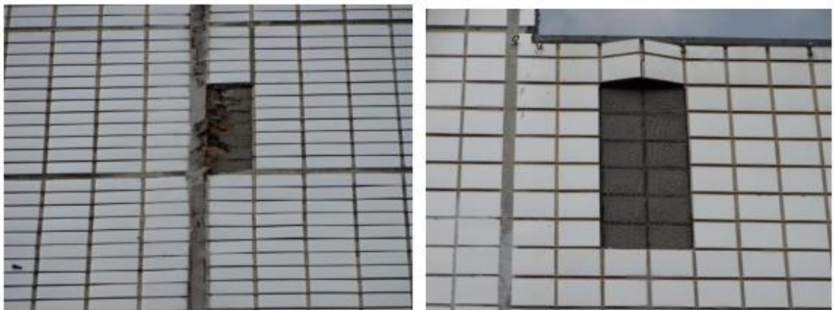
Figura 15 - Deslocamento Encontrado no Edifício Analisado.
