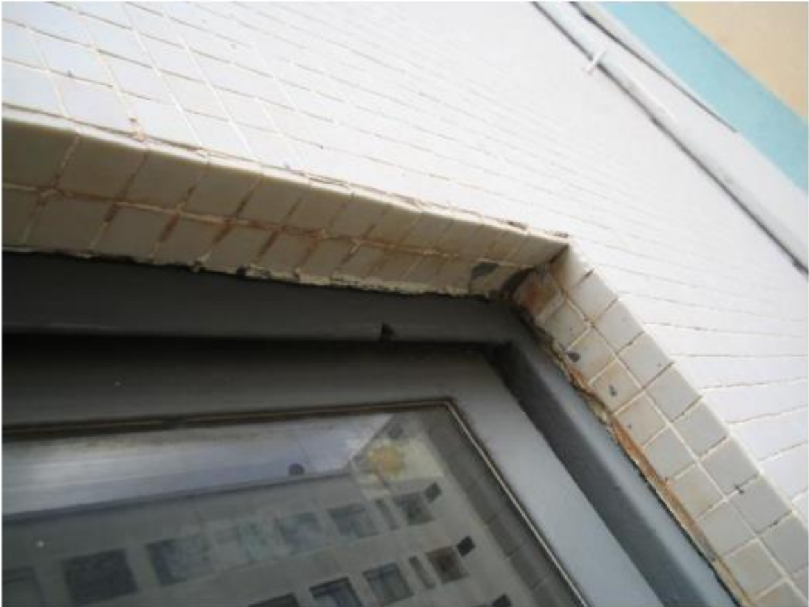
Figura 10 - Falha na vedação
