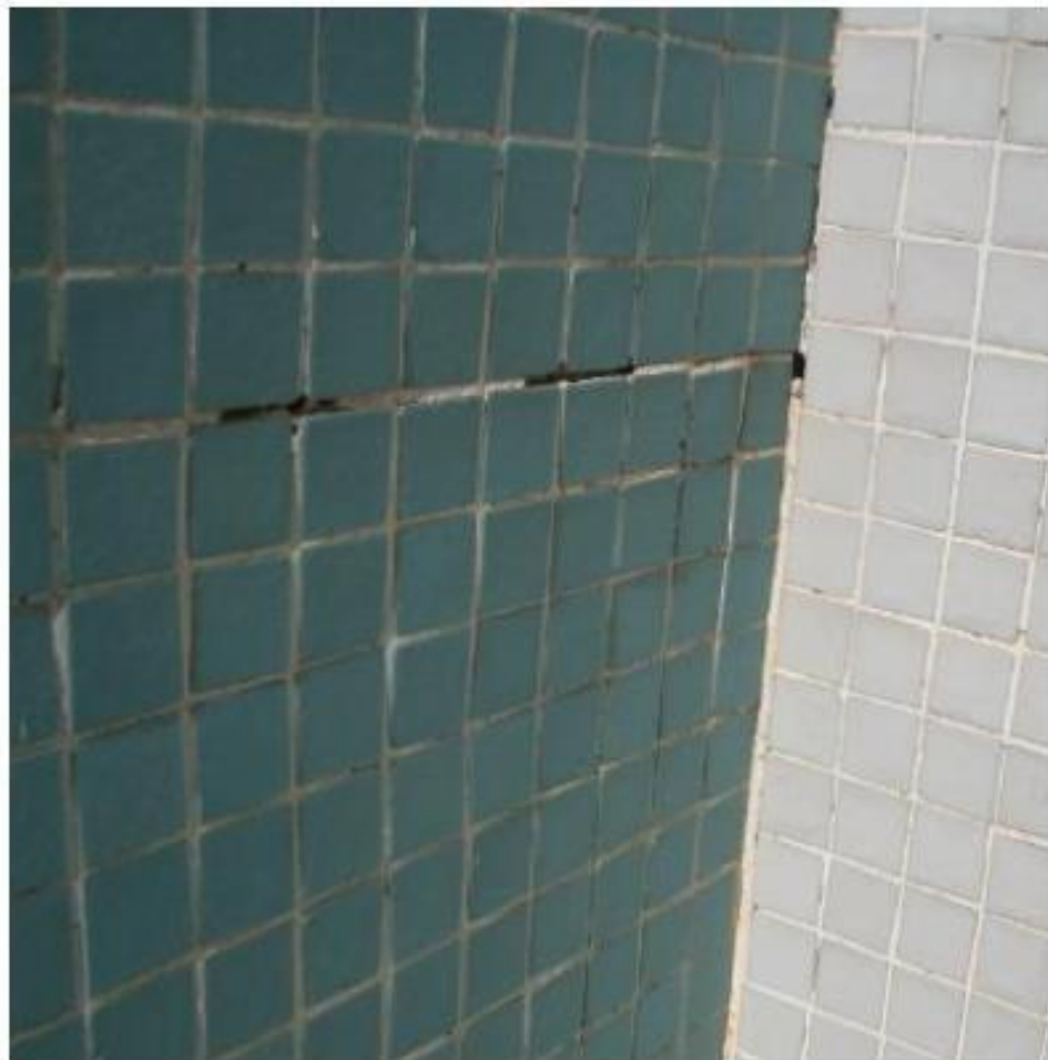
Figura 8 - Falha no Rejunte
