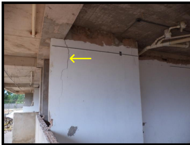
Figura 11 - Foto da rachadura no pavimento térreo
