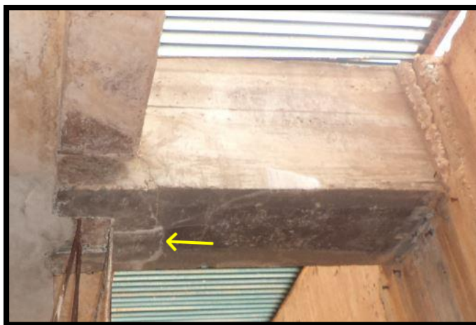
Figura 22 - Foto da trinca no subsolo
