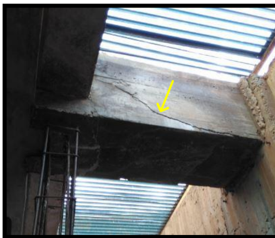
Figura 23 - Foto da rachadura no subsolo
