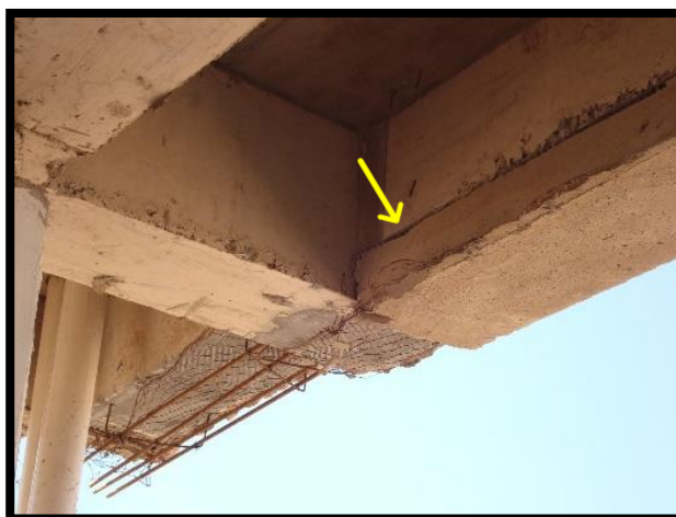
Figura 20 - Foto da brecha no pavimento superior
