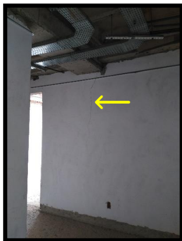
Figura 12 - Foto da trinca no pavimento térreo
