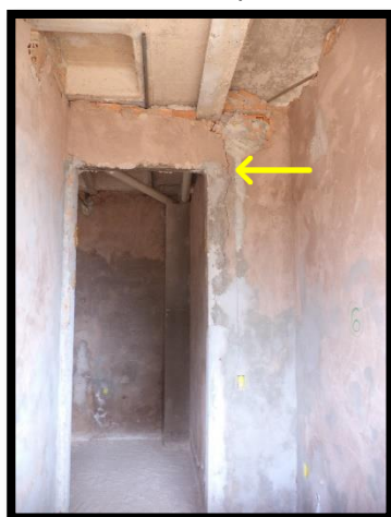
Figura 13 - Foto da trinca no pavimento térreo
