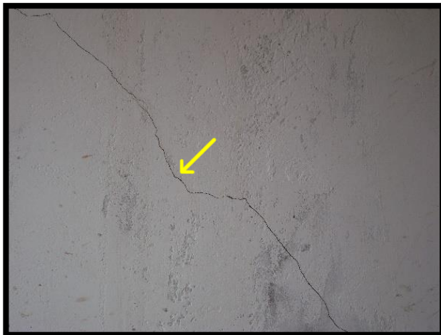
Figura 18 - Foto da fissura no pavimento superior
