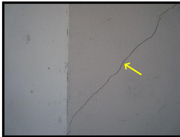
Figura 15 - Foto da trinca no pavimento superior
