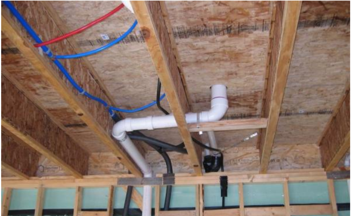
Figura 3.22 – Instalação hidrossanitária utilizando sistema PEX para alimentação e tubos de PVC para esgoto.
