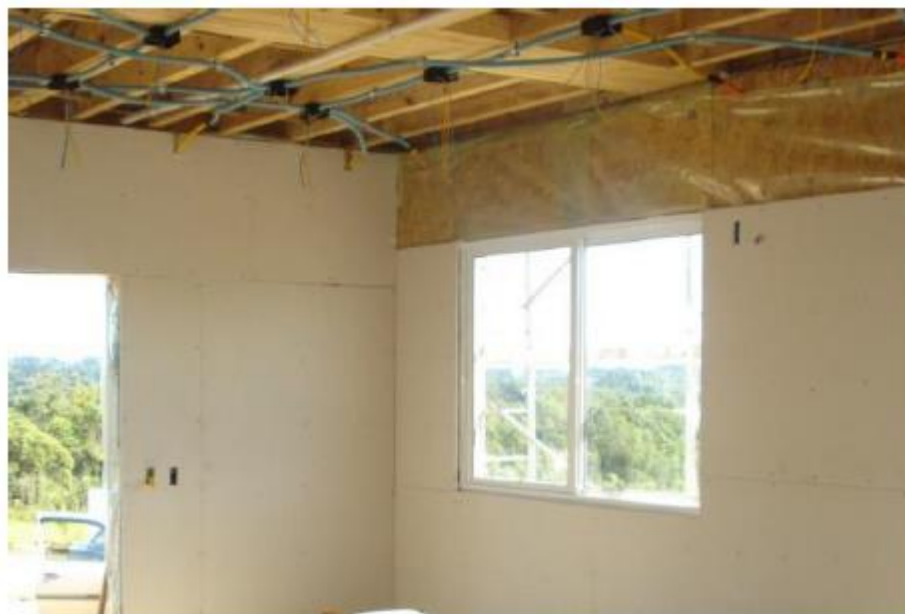
Figura 3.23 – Instalações elétricas em construção em wood frame (J, PEREIRA. 2015)
