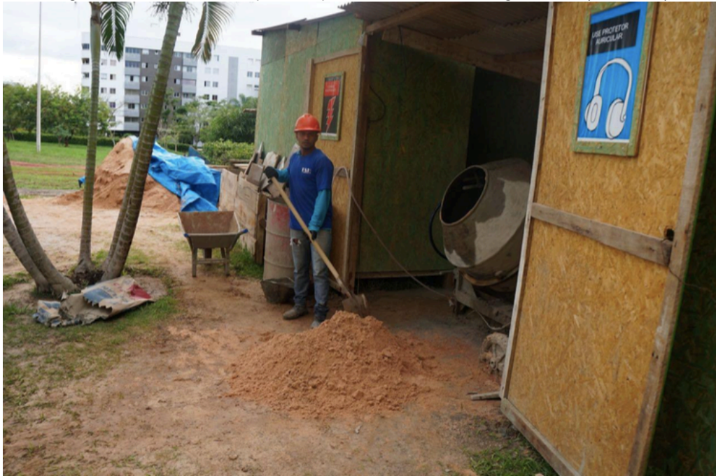
Figura 17 - Ausência de padiola para elaboração da argamassa (22/11/16)
