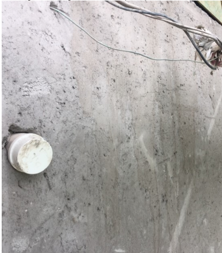
Figura 20 - Argamassa com imperfeições e cavidades.
