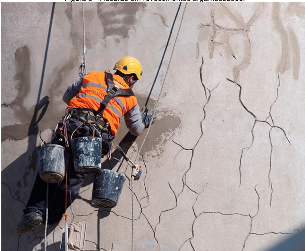
Figura 5 - Fissuras em revestimentos argamassados.
