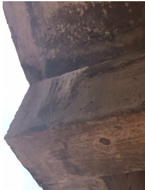
Figura 3: Eflorescência em estrutura.
