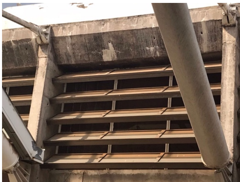
Figura 9: Eflorescência em estrutura.
