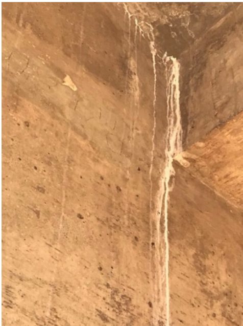
Figura 2: Eflorescência em estrutura.
