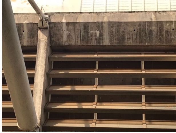
Figura 1: Eflorescência em estrutura.
