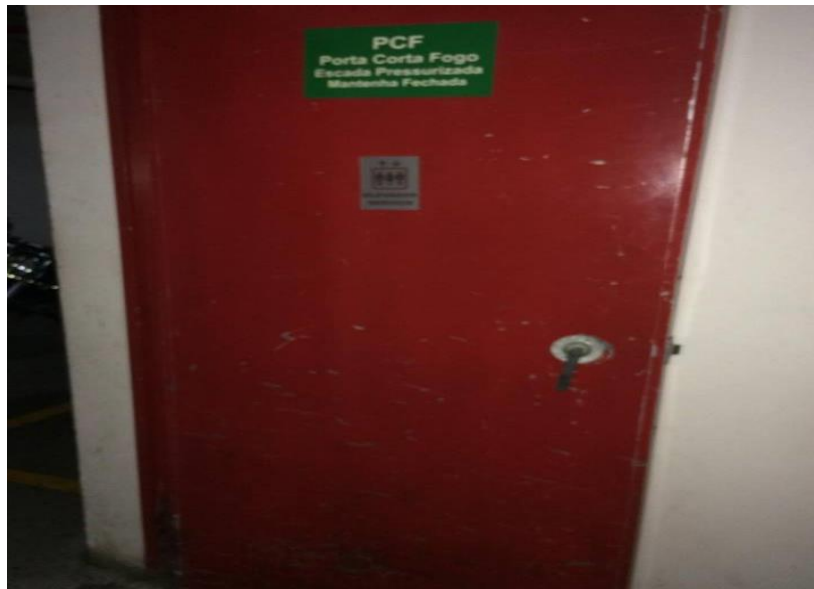
Figura 14 - Exemplo de porta corta fogo com pintura deteriorada. (Autor, 2017).
