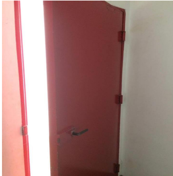
Figura 13 - Porta corta fogo com regulagem das dobradiças comprometidas. (Autor, 2017).
