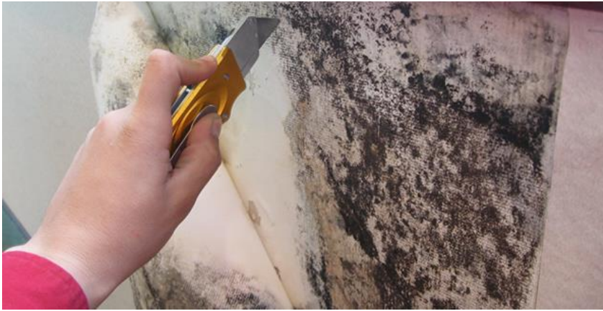
Figura 4 – Umidade em estruturas.
