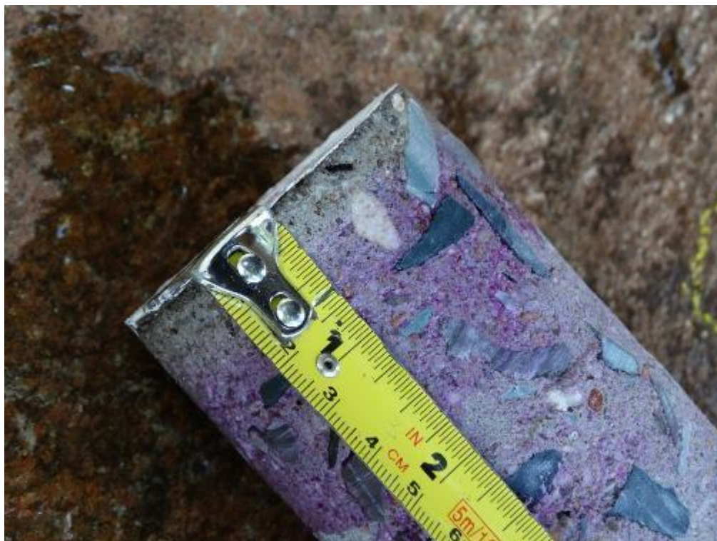
Figura 36 – Medição da frente de carbonatação em testemunhos de concreto.
