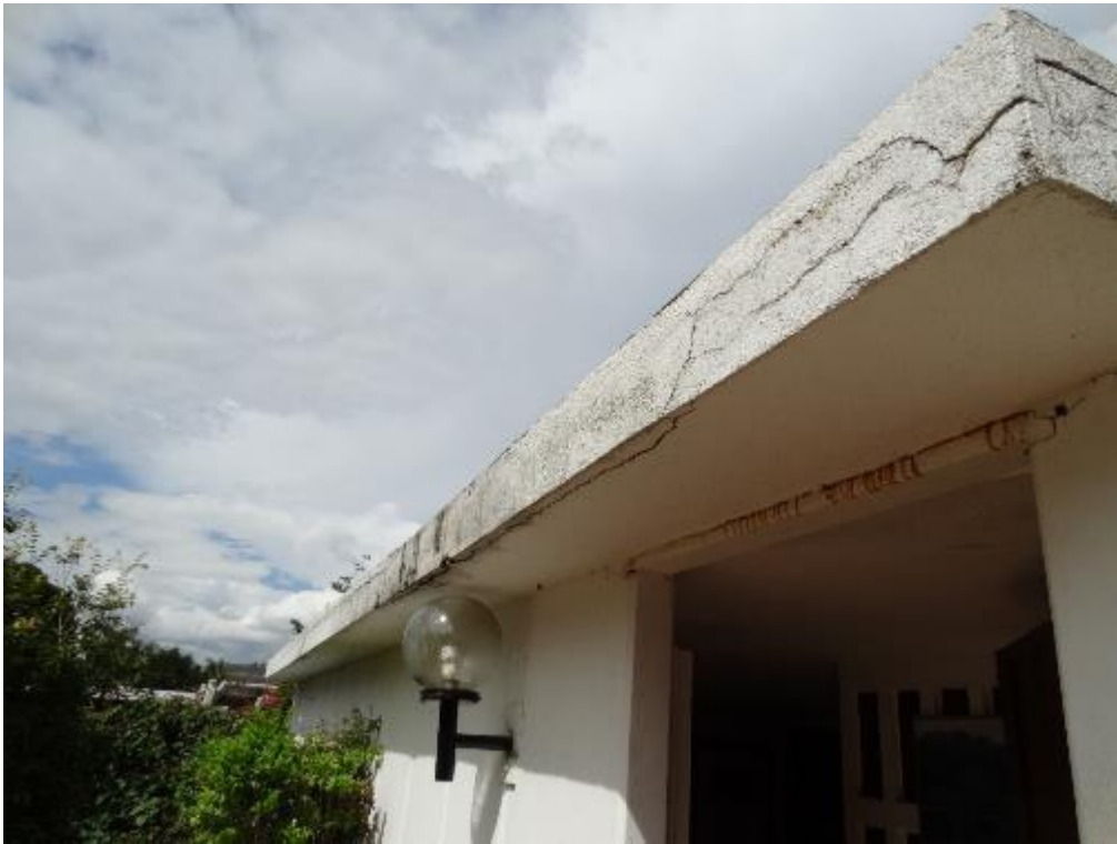
Figura 12 – Trincas/fissuras em laje da residência de funcionário.
