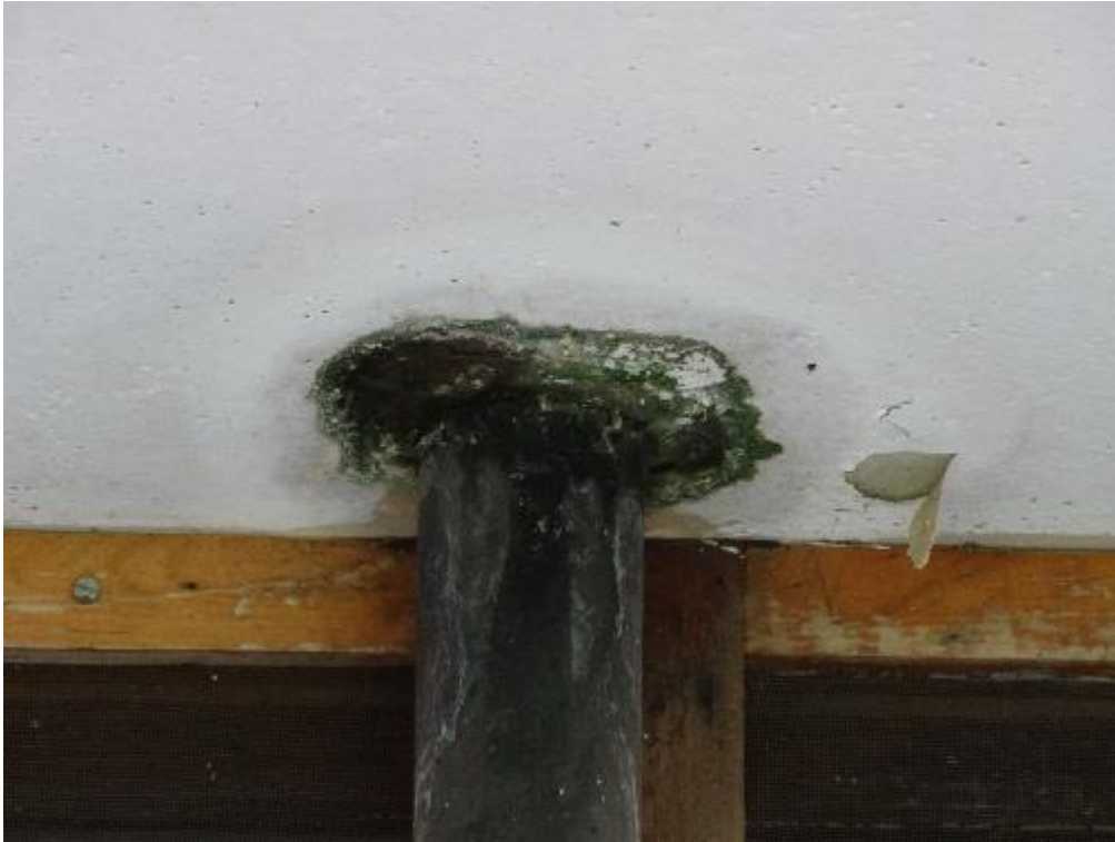
Figura 7 – infiltração nas tubulações aparentes na área externa.
