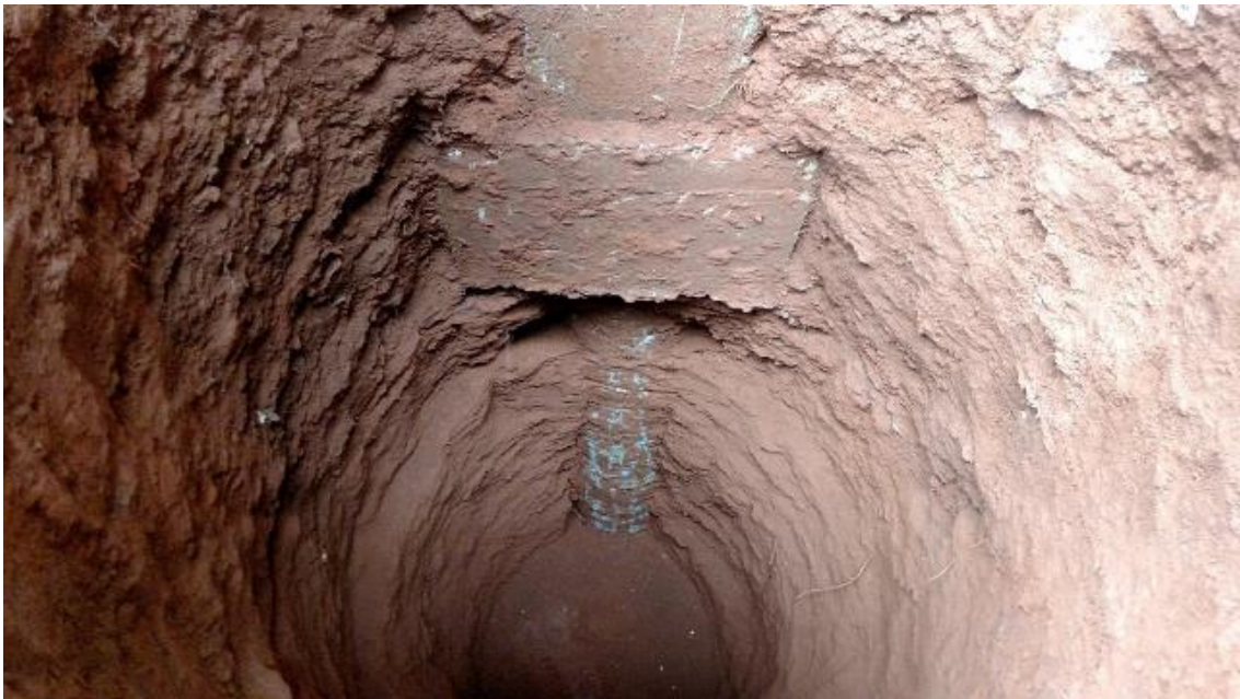
Figura 43 – Estaca abaixo do bloco de coroamento (início da estaca a 1,40 m do nível do terreno).
