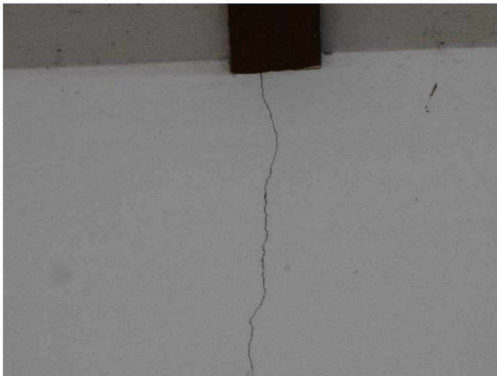
Figura 14 – Detalhe da trinca/fissura da garagem.
