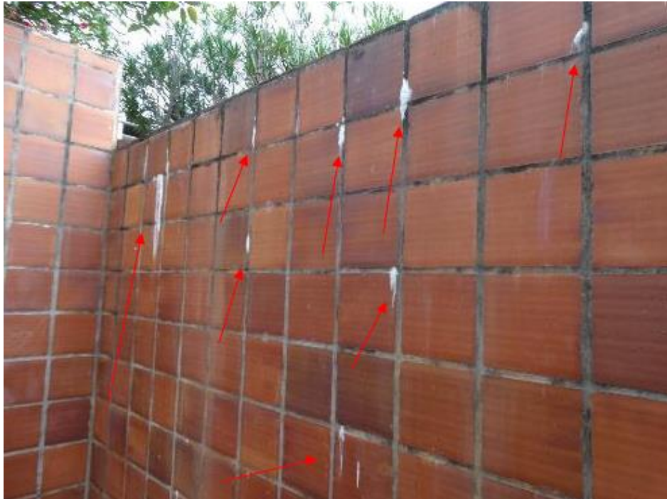
Figura 15 – Pontos de acúmulo de lixiviação na superfície de revestimento cerâmico.
