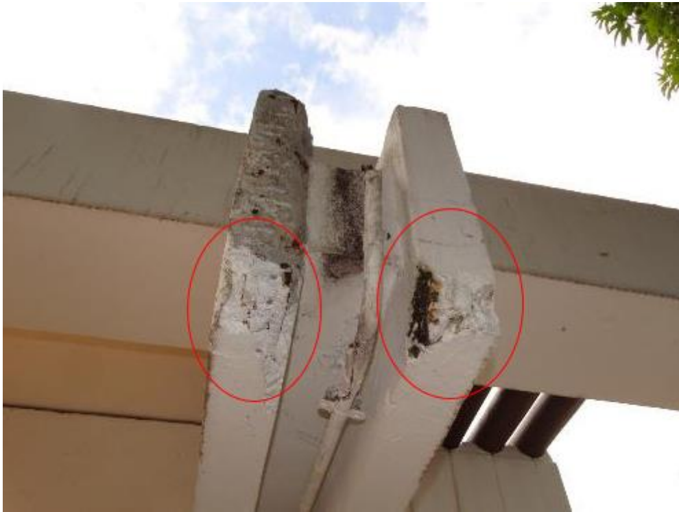
Figura 18 – Viga com armadura exposta.
