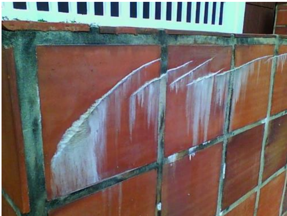
Figura 16 – Eflorescência na superfície de revestimento cerâmico. (Fotografia real)
