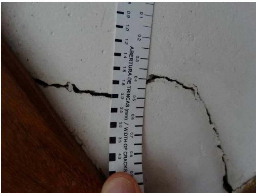
Figura 11 – Trinca/fissura no corredor do escritório.
