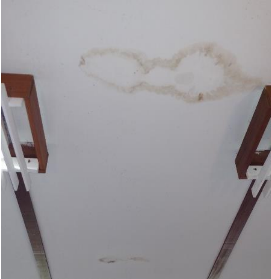
Figura 5 – Infiltração no escritório da residência principal.
