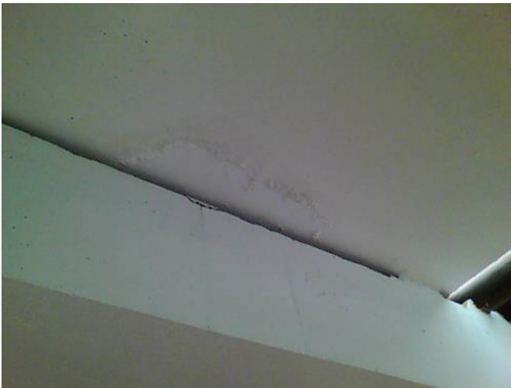
Figura 8 – Infiltração na varanda da residência principal. (Fotografia real)
