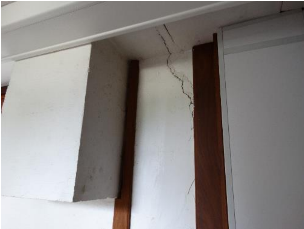
Figura 10 – Trinca/fissura no corredor do escritório.
