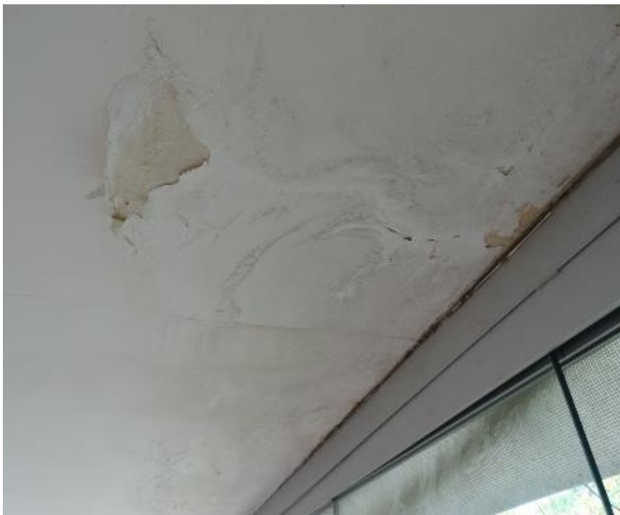
Figura 6 – Infiltração no interior da residência de funcionário.
