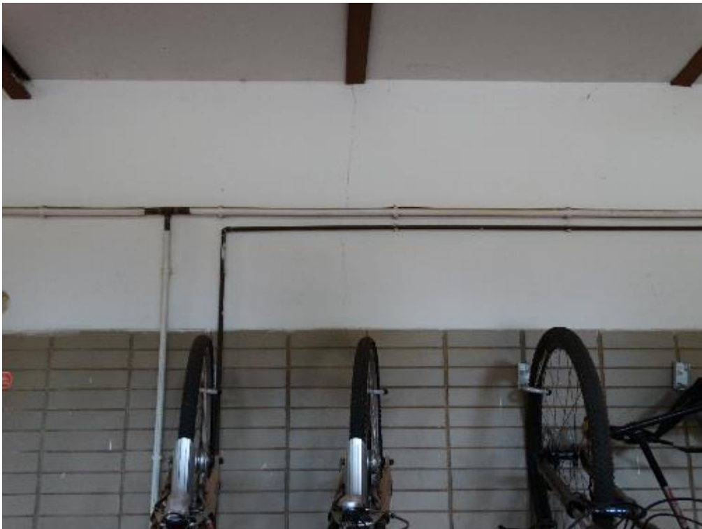
Figura 13 – Trinca/fissura na garagem.
