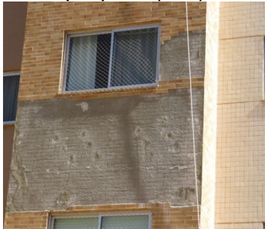
Figura 9 - Deslocamento do revestimento cerâmico na Fachada Posterior de frente para piscina (Norte)
