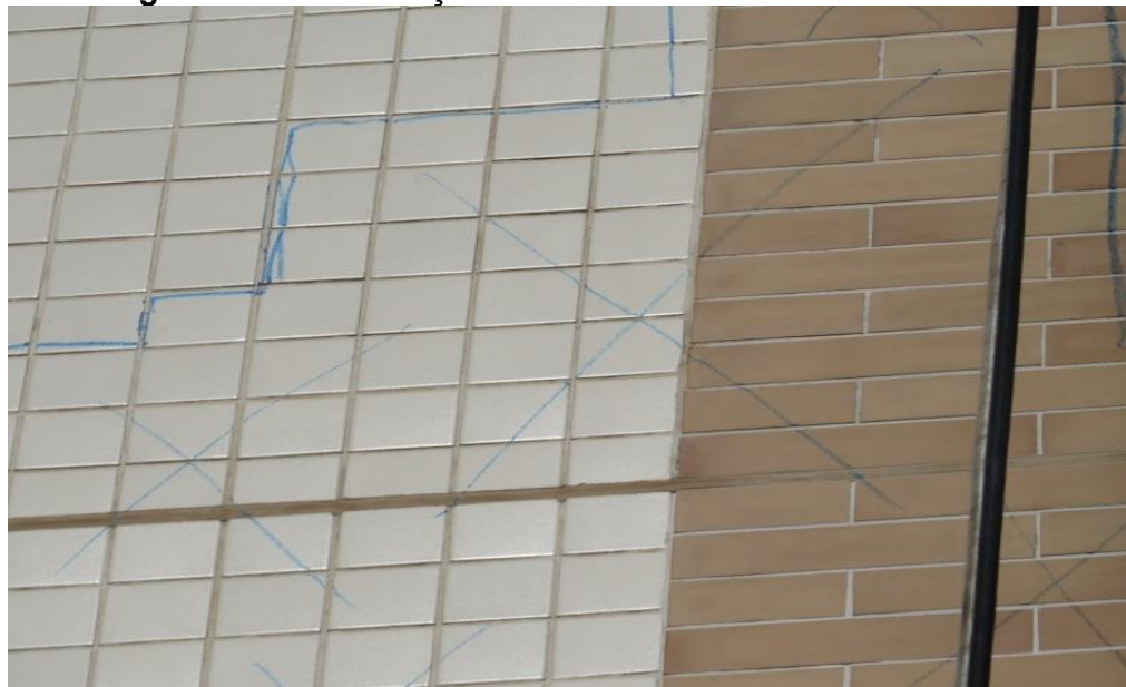
Figura 21 – Demarcação de área com som oco/cavo in loco
