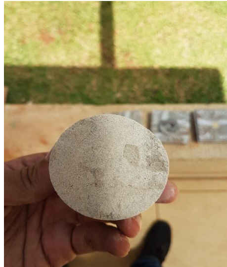
Figura 30 – Problema de aderência entre camadas do emboço
