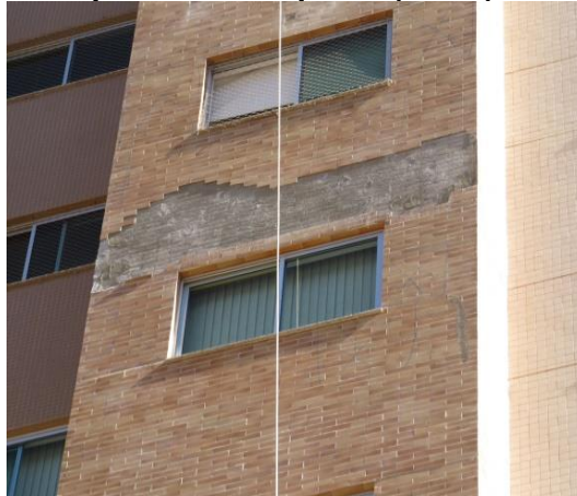
Figura 8 – Deslocamento do revestimento cerâmico na Fachada Posterior de frente para churrasqueira (Norte)
