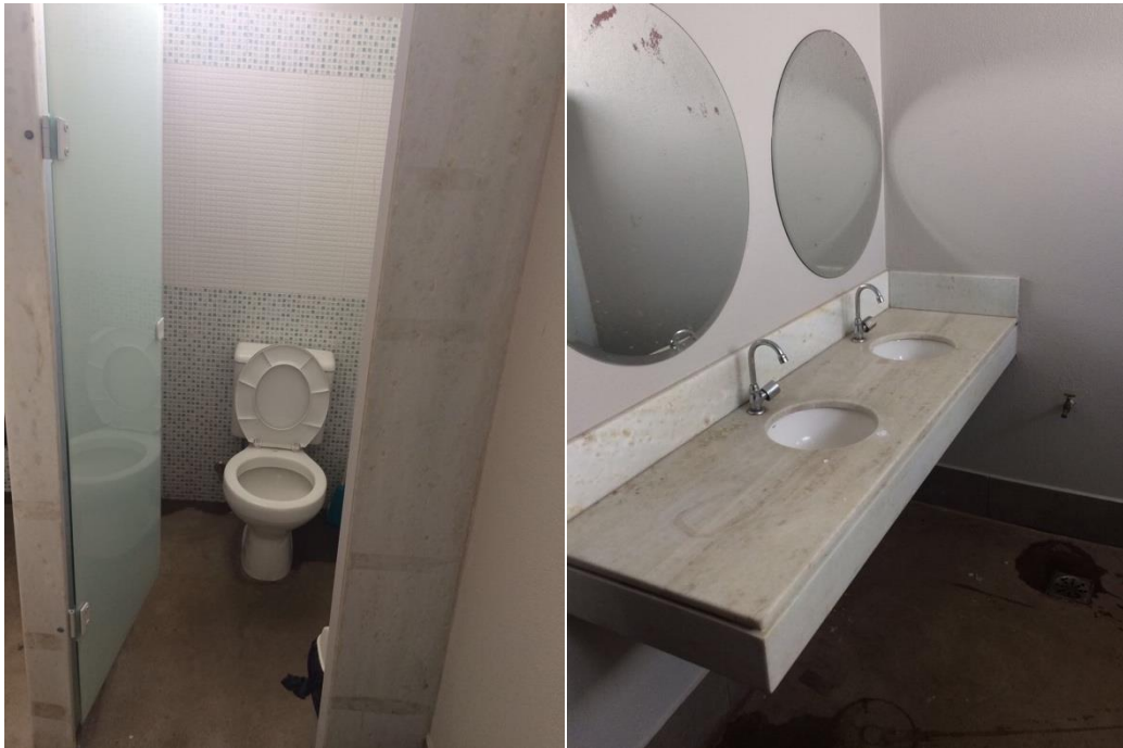
Figura 17a e 17b - Manutenção corretiva realizada para o problema "G"
