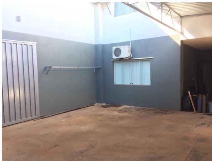
Figura 5 - Manutenção corretiva realizada para o problema "A"
