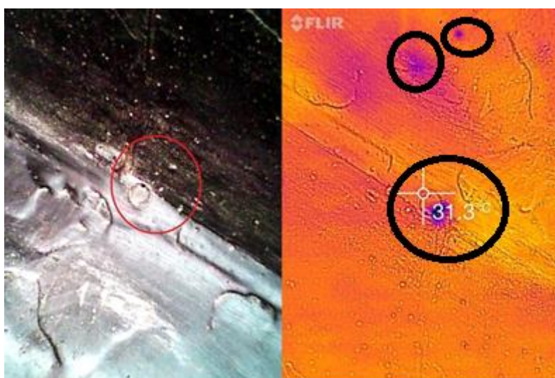
Figura 12: Possível infiltração na região da emenda do rodapé (I1)
