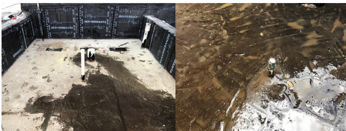
Figura 27: Visão da Área 03 após o teste de estanqueidade
