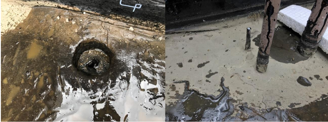
Figura 344: Acúmulo de água após o teste de estanqueidade devido a imperfeições na manta e na superfície
