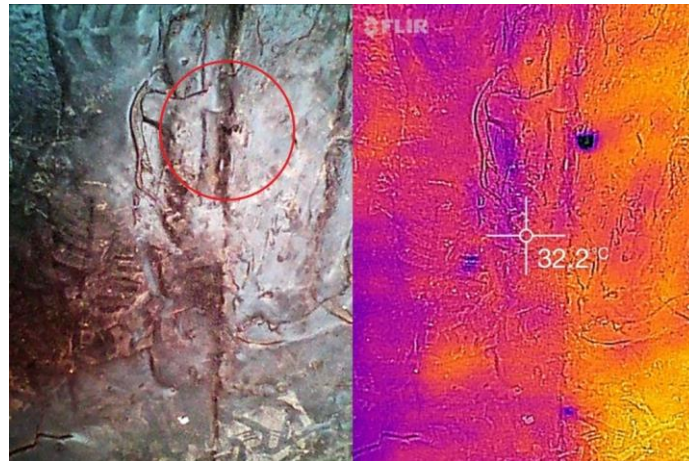
Figura 18: Infiltração no transpasse da emenda entre mantas (I2)
