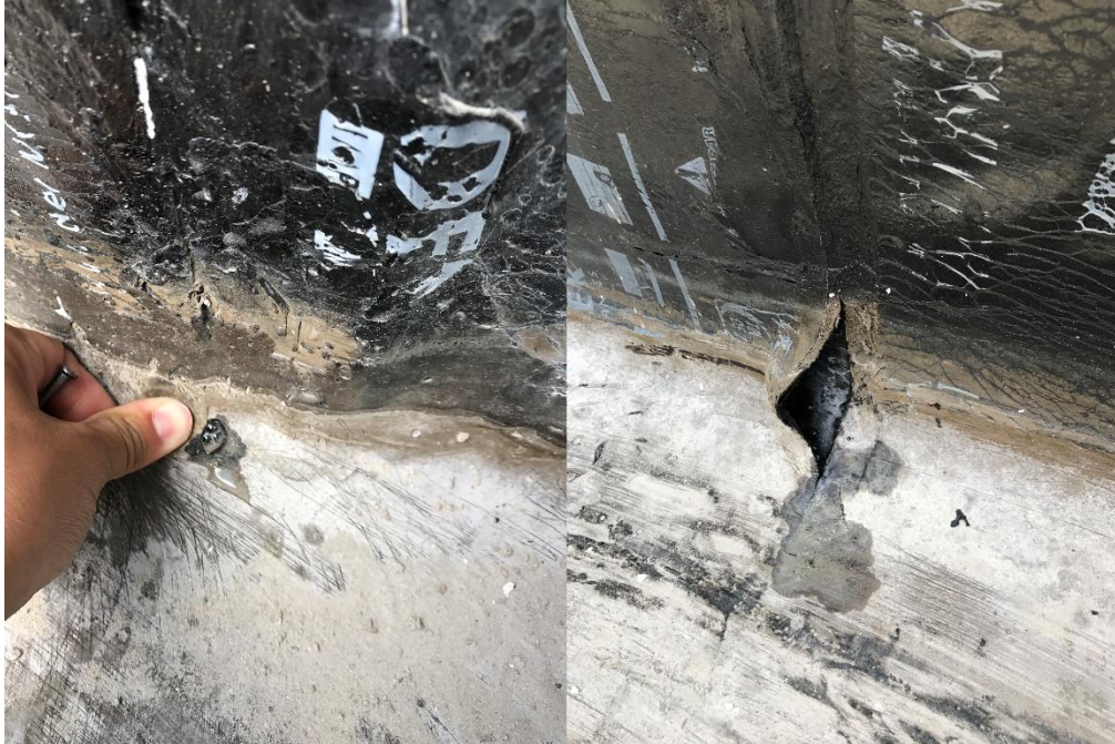
Figura 38: Falha de execução na emenda entre mantas (14)
