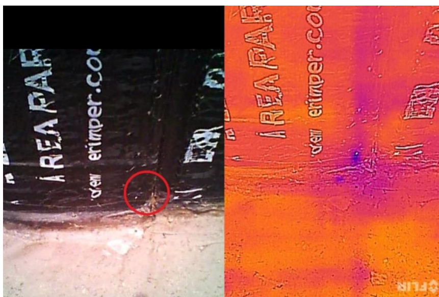
Figura 28: Possível ponto de infiltração entre mantas (I1)
