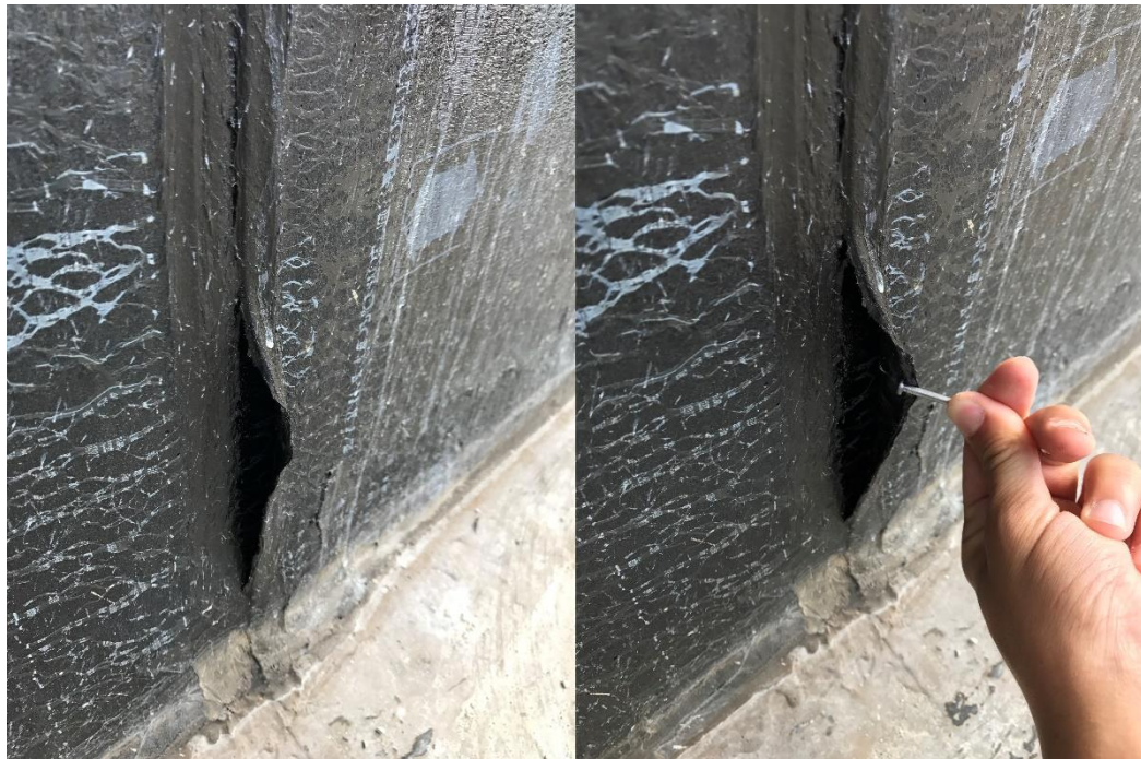
Figura 35: Falha de execução na emenda entre mantas (I1)
