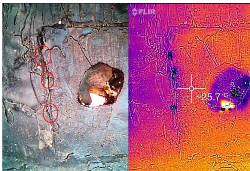
Figura 13: Pontos com presença de água na sobre manta do ralo.
