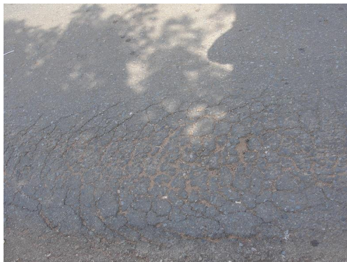
Figura 1 - Pavimento em mal estado de conservação.
