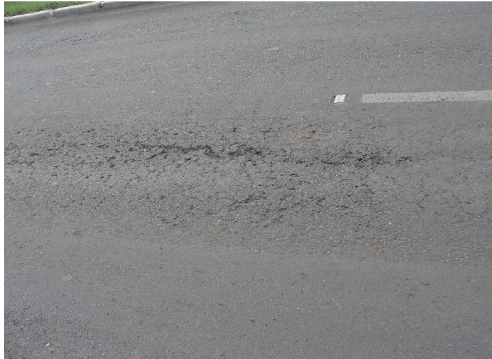
Figura 2 - Pavimento em mal estado de conservação.
