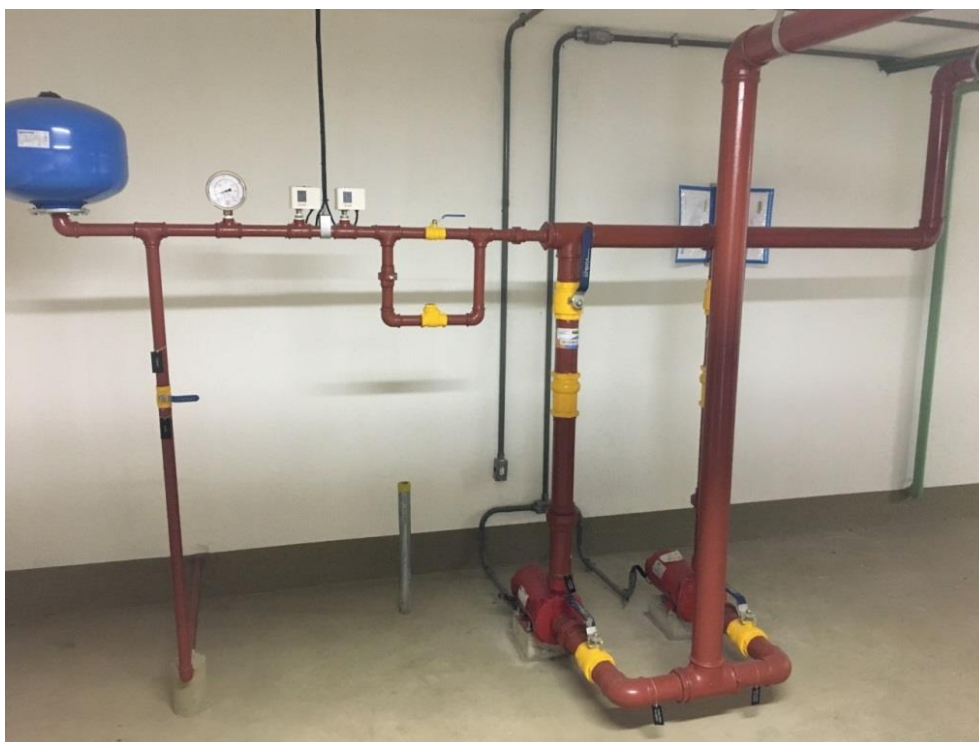
Figura 20 - Conjunto Motor Bomba de Incêndio II
