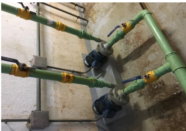
Figura 19-Conjunto Motor Bomba Recalque
