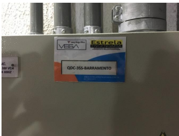
Figura 23 - TAG de quadro elétrico
