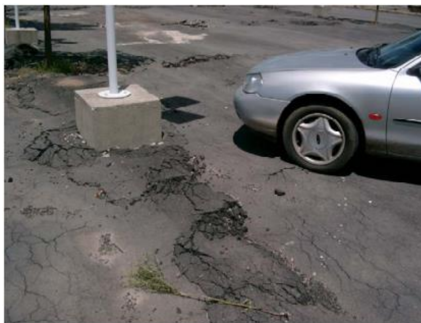
Figura 6 – Expansão causada pela escória de aciaria em um estacionamento de um hospital localizado em Vitória, ES (Raposo, 2005)
