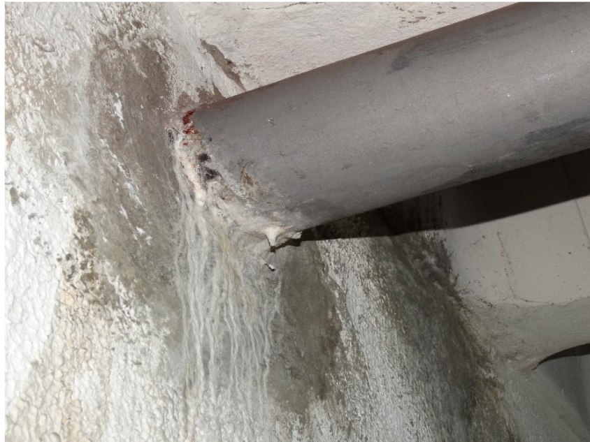
Figura 14 - Falha na passagem das tubulações da 311 norte
