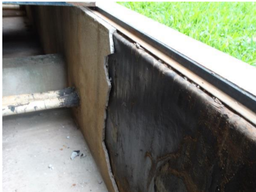
Figura 13 - Falha no sistema de impermeabilização na 116 norte
