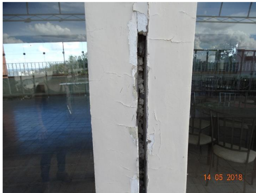
Figura 21 - Pilar com junta praticamente inexistente – Laudo da 103 sul
