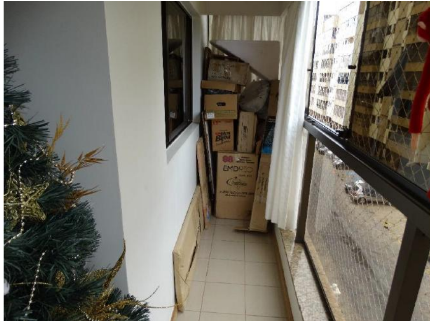
Figura 7 - Acúmulo de caixas sobre laje em balanço na 311 norte
