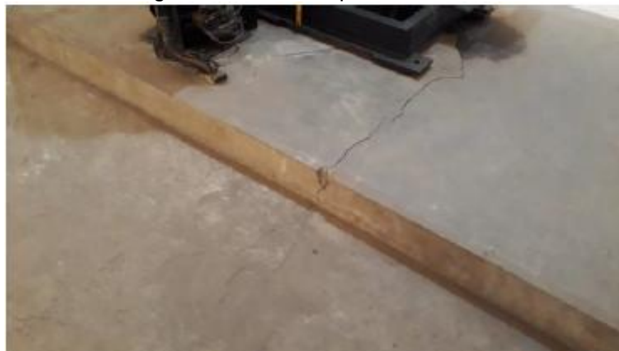
Figura 6 - Trinca no piso da 103 sul
