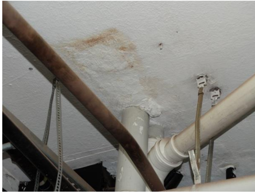
Figura 12 - Infiltração na laje da 116 norte
