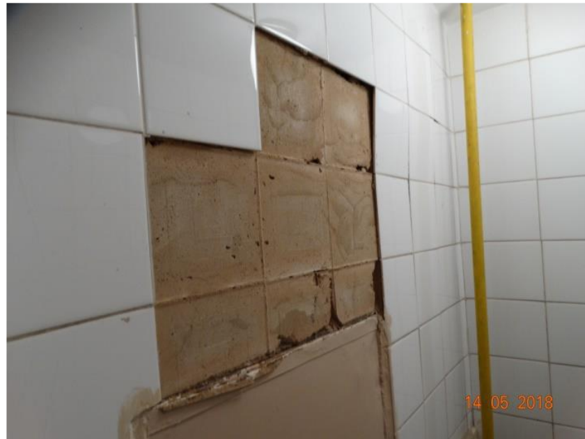
Figura 19 - Deslocamento de revestimento cerâmico – Laudo da 103 sul
