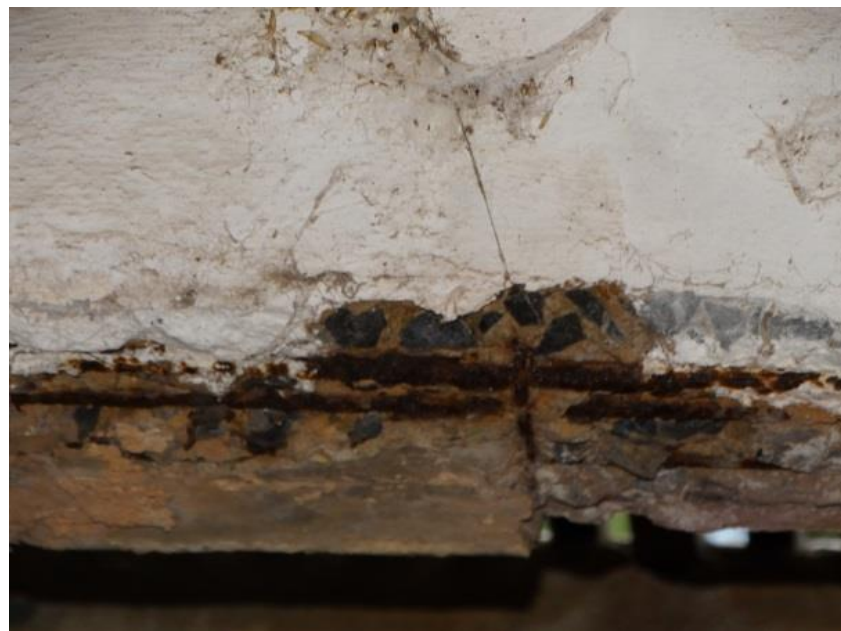
Figura 10 - Viga com cobertura insuficiente na 116 norte
