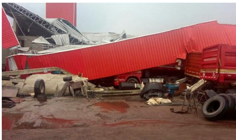
Figura 1 - Galpão de transportadora derrubado pela força do vento no bairro Tijucas em Florianópolis – Santa Catarina, em novembro de 2016.
