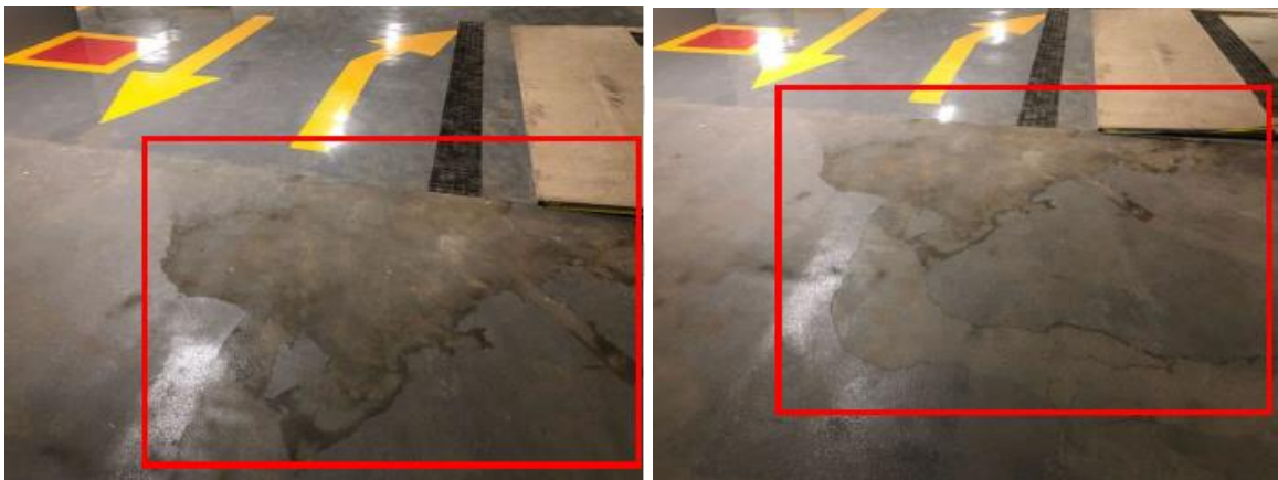
Fotografia 21 - Falhas e desgaste no piso do 2º SS
