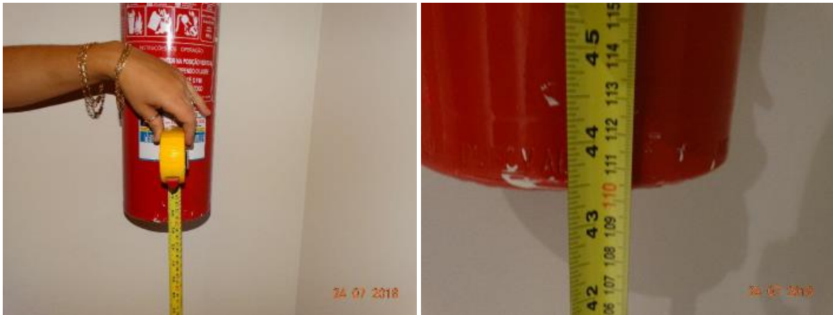
Fotografia 29 - Altura do fundo do extintor em relação ao piso medida com 1,10 metros
