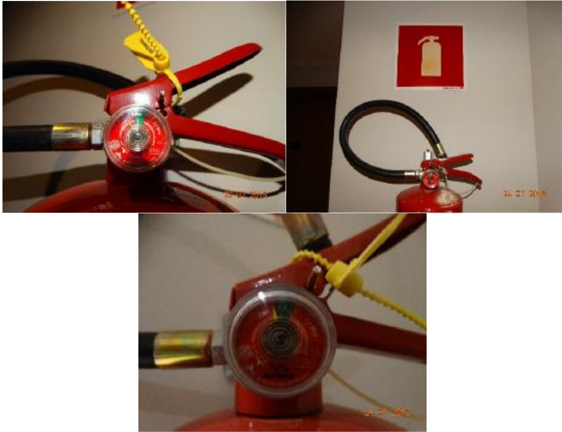
Fotografia 31 - Extintores identificados com pressão de operação baixa (despressurização): (a) 4º Pavimento Junta A; (b) 6º Pavimento Junta C; (c) 1º Pavimento da Junta D.
