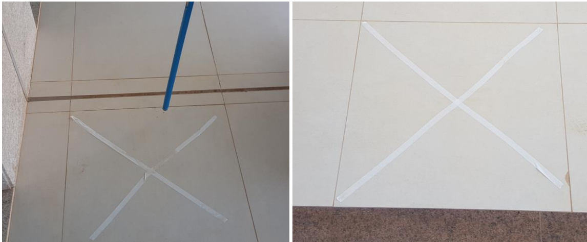
Fotografia 02 - Ensaio de percussão: (a) haste de madeira usada para golpear as peças; (b) peça marcada com fita branca visível quando houve constatação de som cavo/oco
