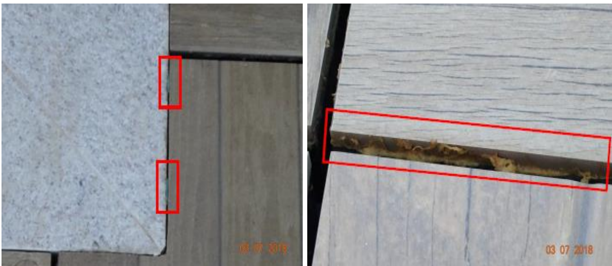
Fotografia 06 - Peças do piso elevado com resíduos de espaçadores e sujeira acumulada
