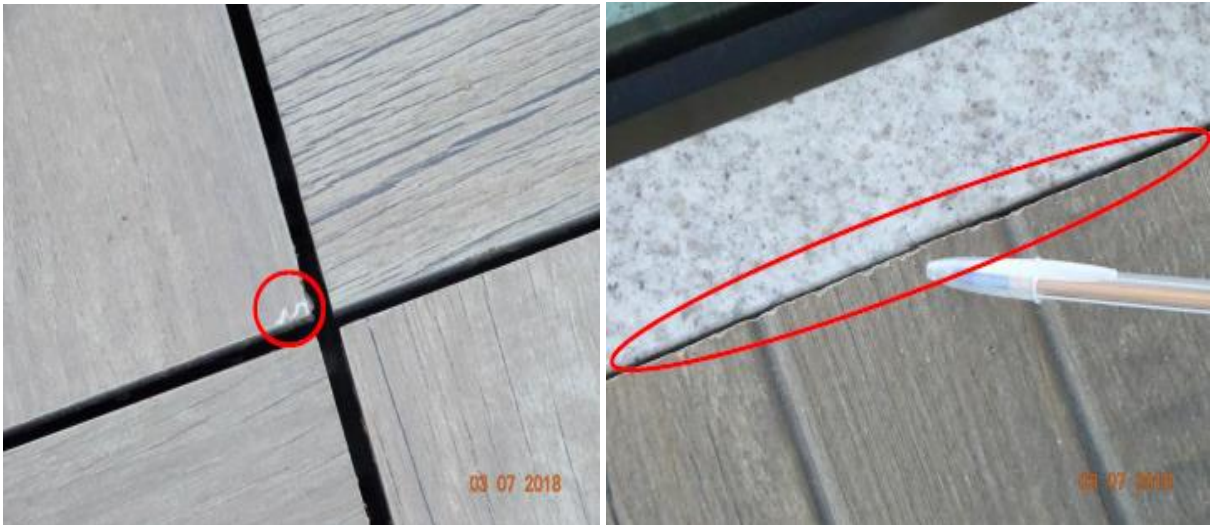
Fotografia 05 - Peças do piso elevado danificadas nas bordas
