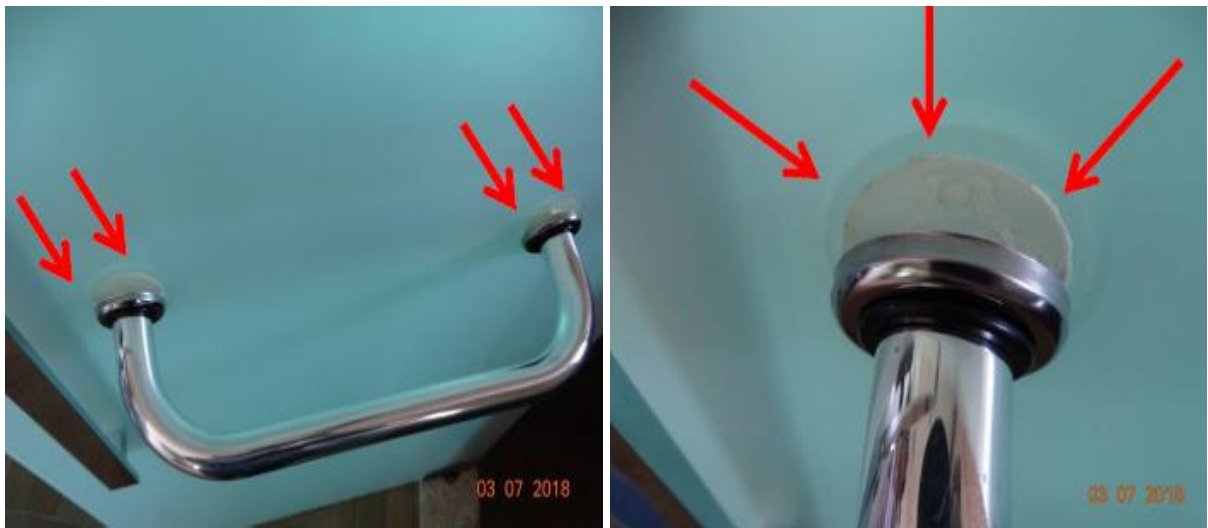
Fotografia 13 - Barra de apoio descolando da porta de vidro do sanitário masculino acessível
