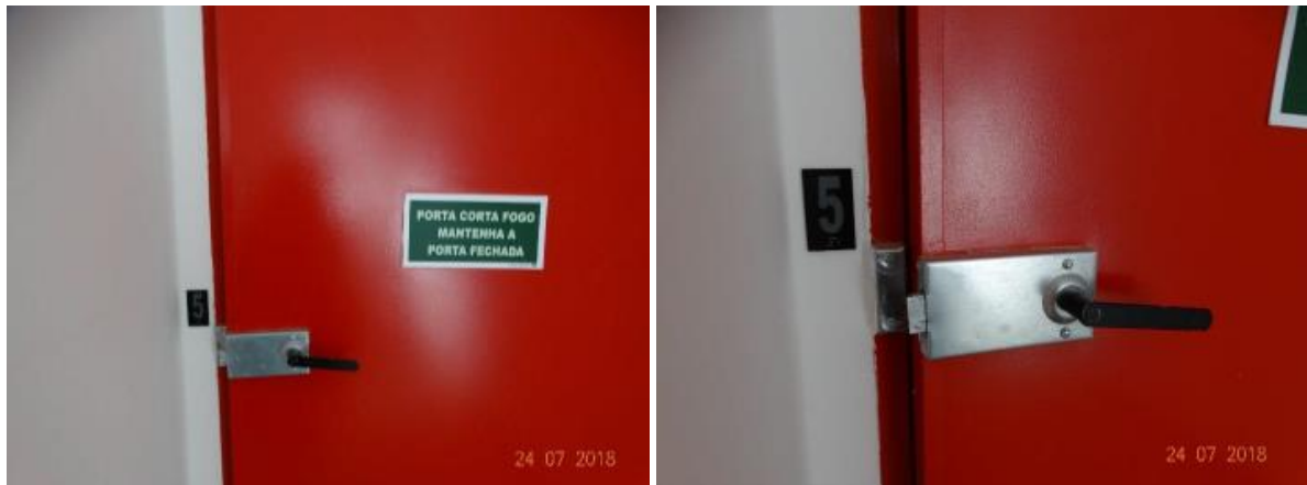
Fotografia 36 - Dispositivo de fechamento automático da porta corta-fogo com defeito (5º Pavimento Junta D)
