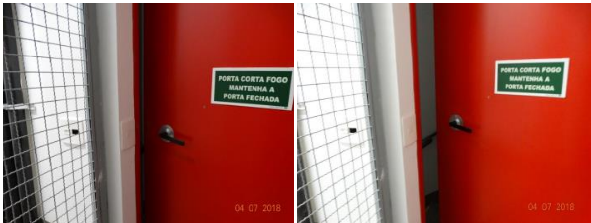
Fotografia 37 - Dispositivo de fechamento automático da porta corta-fogo da casa de máquinas da Junta A com defeito
