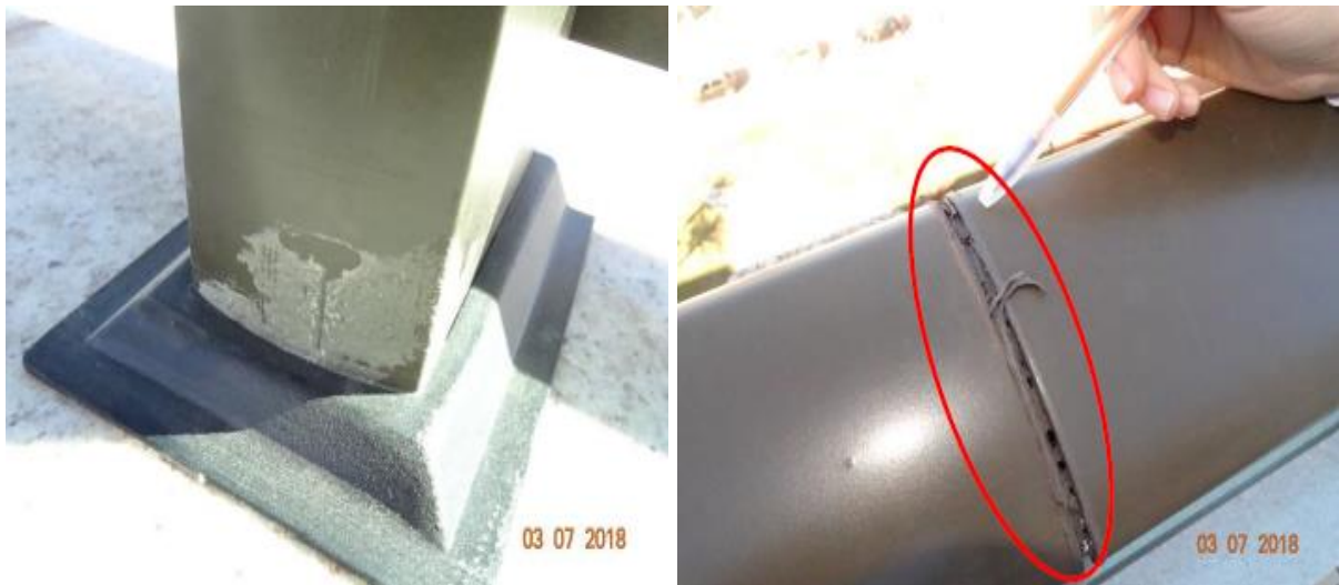
Fotografia 09 - Falhas no guarda-corpo: (a) falha na pintura; (b) falha no silicone entre as peças do guarda-corpo de alumínio
