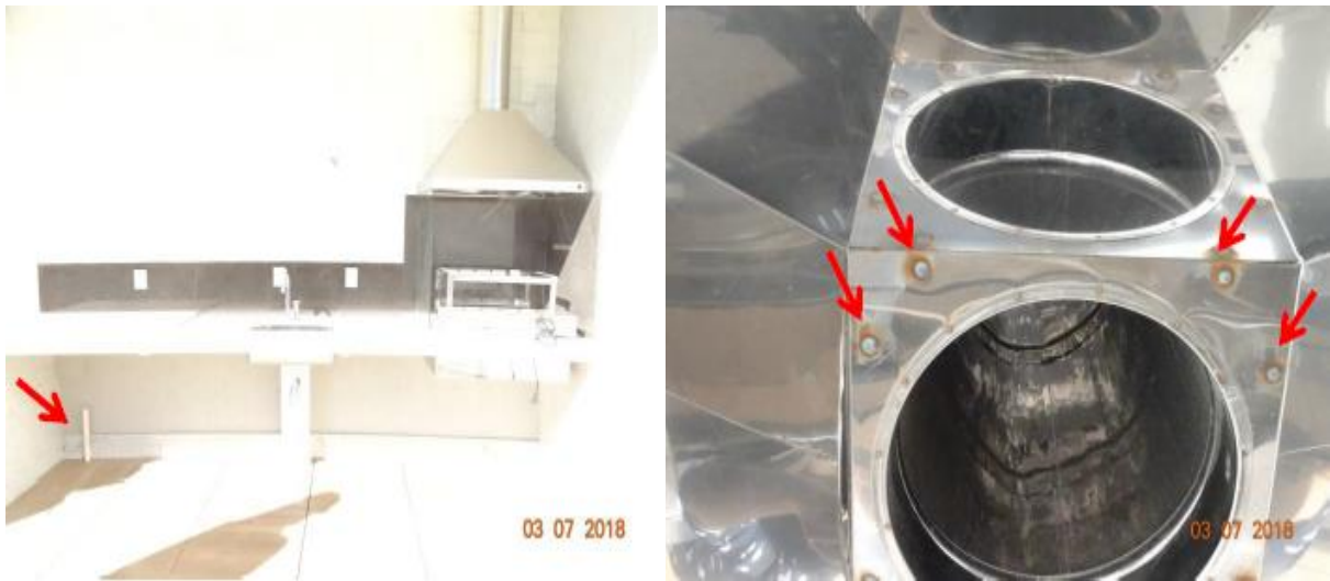
Fotografia 11 – Falhas na área da churrasqueira: (a) tubulação de PVC exposta; (b) pontos de corrosão no interior da coifa
