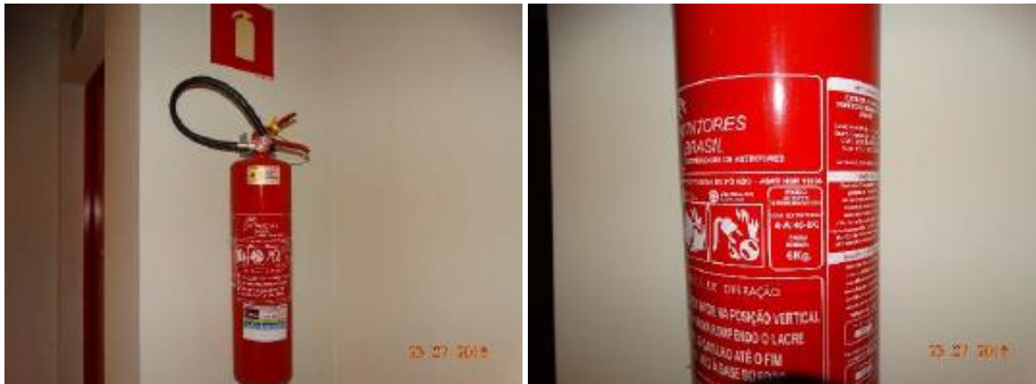
Fotografia 27- Extintor de pó químico ABC instalados
