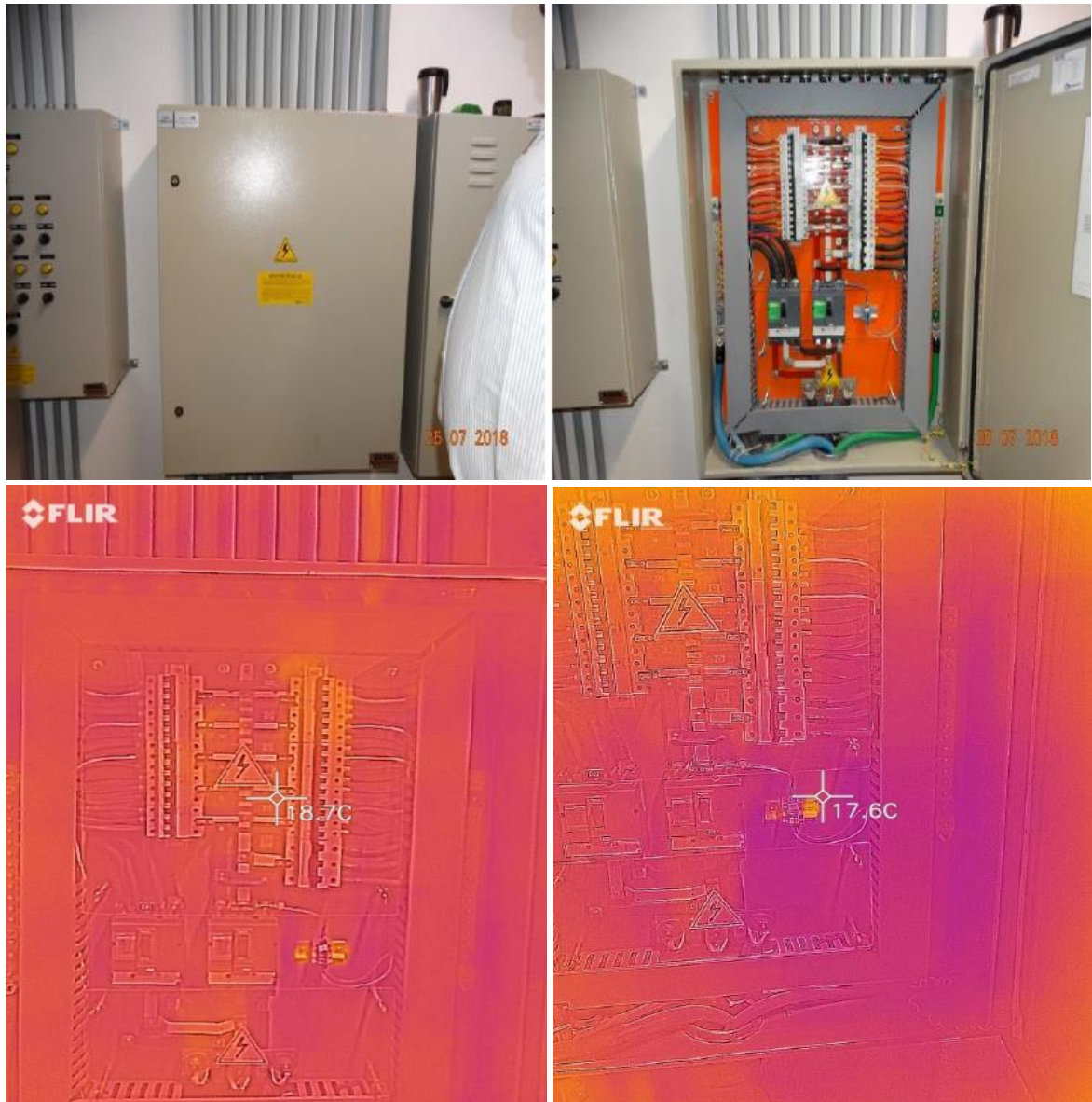
Fotografia 34 - Registro fotográfico e termográfico do Quadro de Força e Serviço
