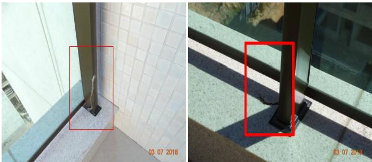
Fotografia 10 - Falhas na instalação do aterramento
