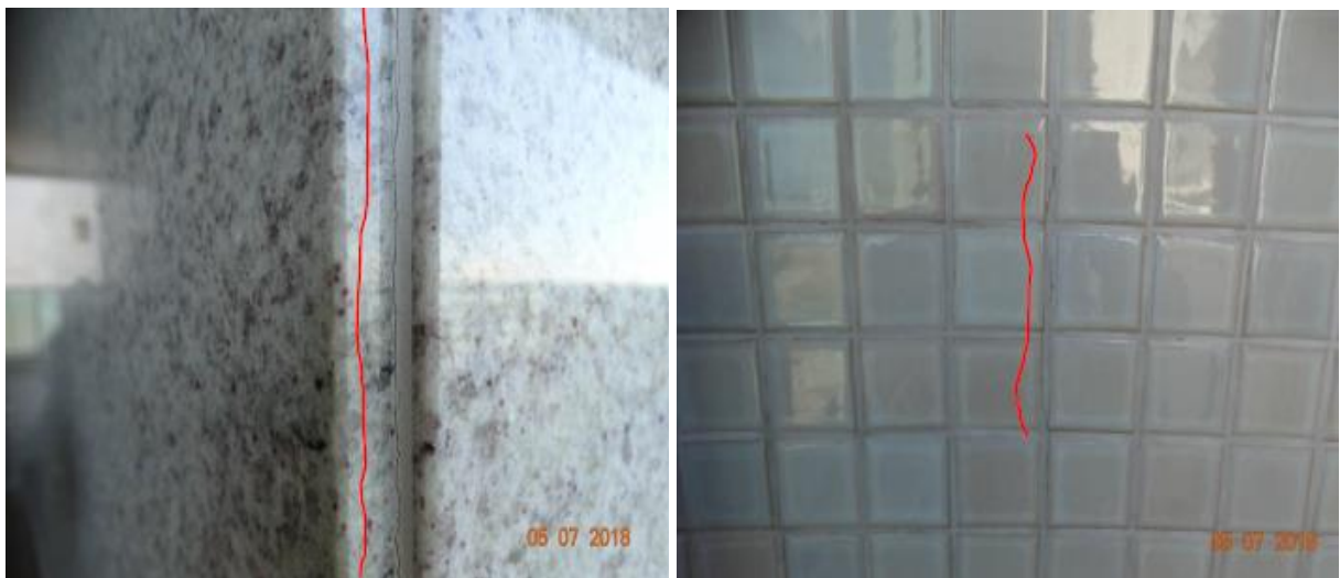
Fotografia 08 - Fissuras no rejunte de peças de granito e de pastilhas de cerâmica
