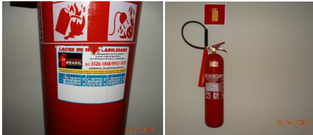
Fotografia 32 - Anomalias referentes às etiquetas de lacre de inviolabilidade dos extintores: (a) lacre violado no extintor do hall de serviço do térreo Junta B; (b) inexistência do lacre no extintor do hall de serviço do térreo Junta C
