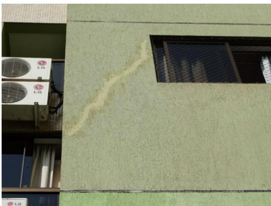
Figura 16 - Trinca/fissura próximo a janela na fachada leste
