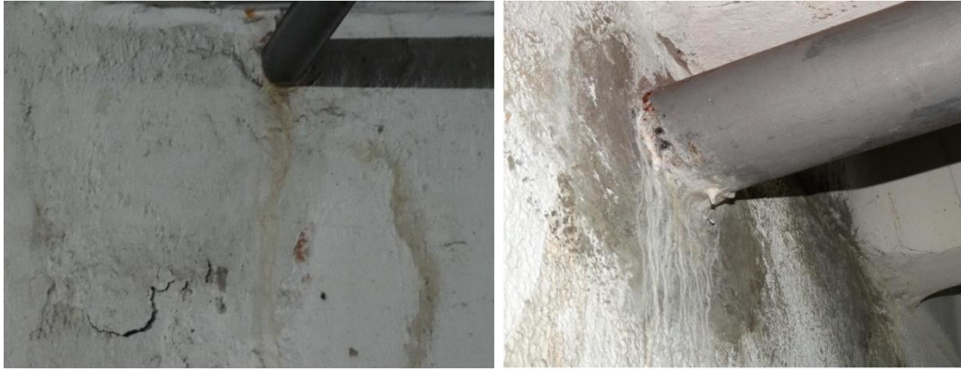
Figuras 24 e 27- Manchas na pintura indicando infiltração
