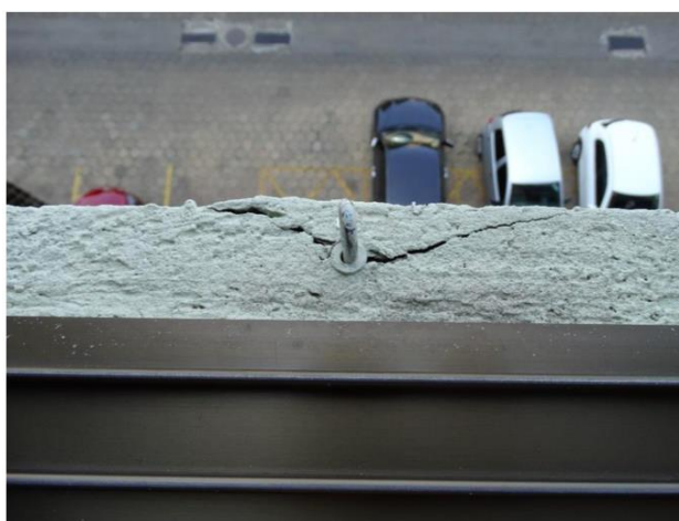
Figura 19 - Trinca/fissura ocasionada pela instalação do gancho de fixação da tela de proteção
