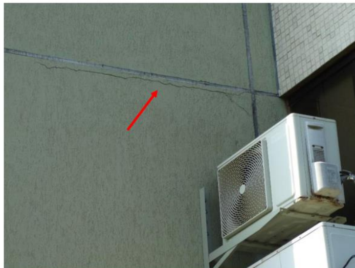
Figura 15 - Trinca/fissura na Fachada próxima a junta de dilatação
