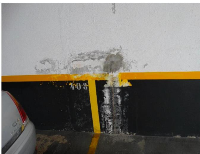
Figura 22 - Infiltração no subsolo
