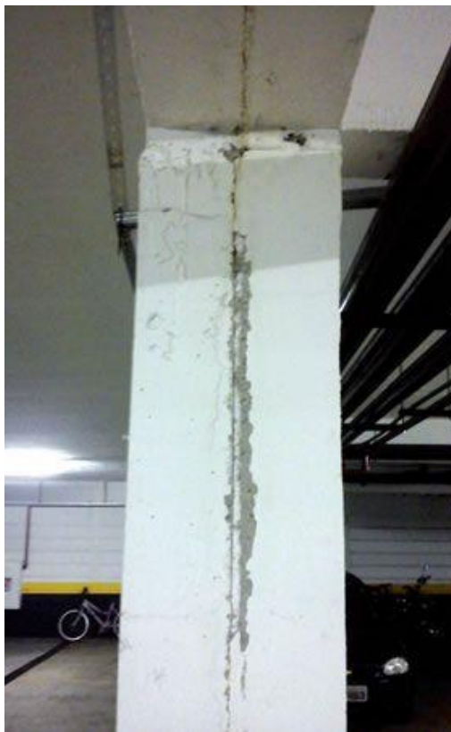
Figura 9 - Patologia em junta de dilatação
