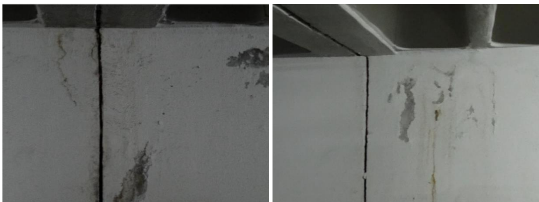
Figuras 26 e 30 - Juntas de dilatação degradadas no subsolo
