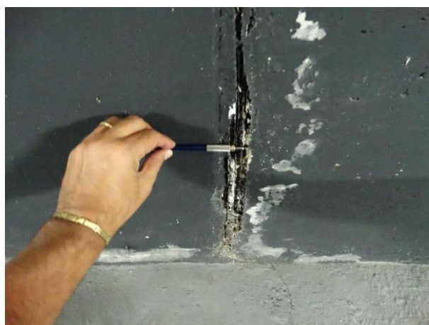
Figura 27 - Junta de dilatação degradada no subsolo
