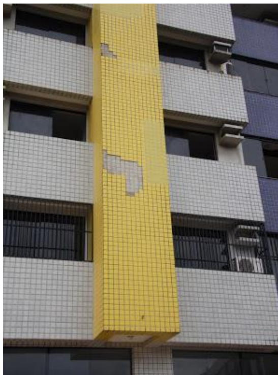
Figura 5 - Deslocamento do revestimento cerâmico em fachada de edifício
