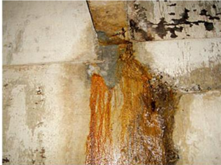
Figura 10- Infiltração em subsolo causando corrosão de armadura
