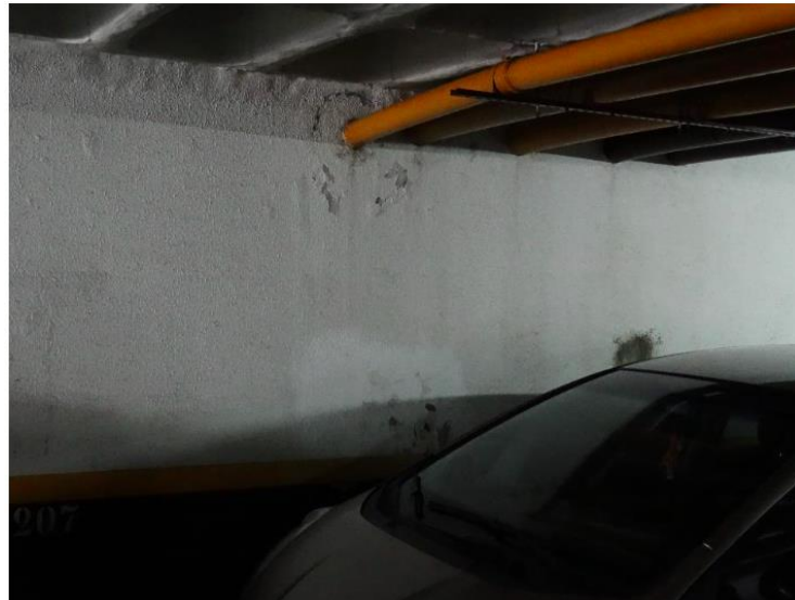
Figura 25 - Infiltração no subsolo
