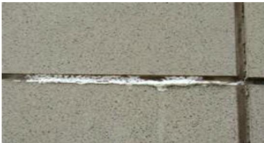
Figura 8 - Eflorescência de rejuntamento
