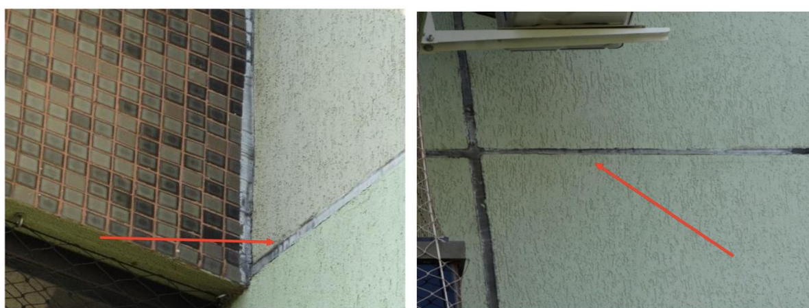
Figuras 18 e 20 - Estado de degradação da junta de dilatação
