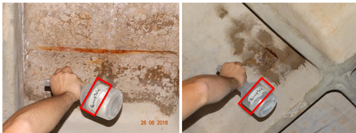
Figura 82 – Ensaio de avaliação da frente de penetração de carbonatação do concreto na laje superior do subsolo da edificação
