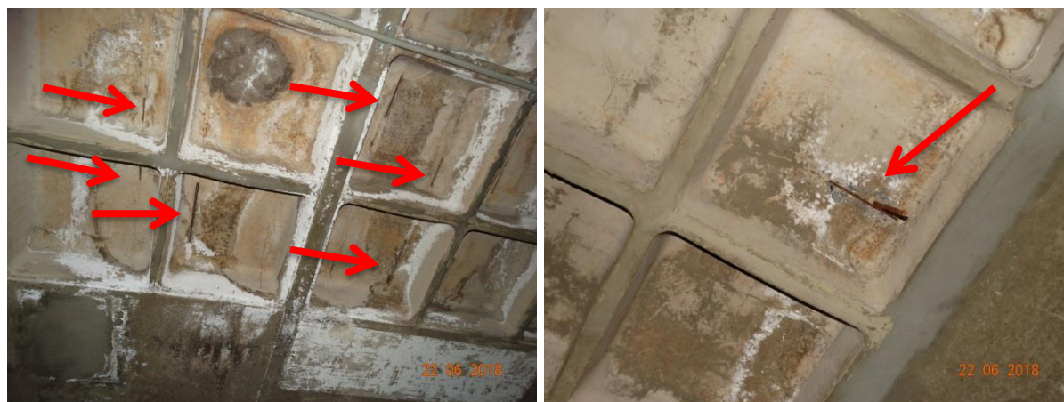
Figura 67 – Corrosão da armadura verificada na laje nervurada do subsolo da edificação
