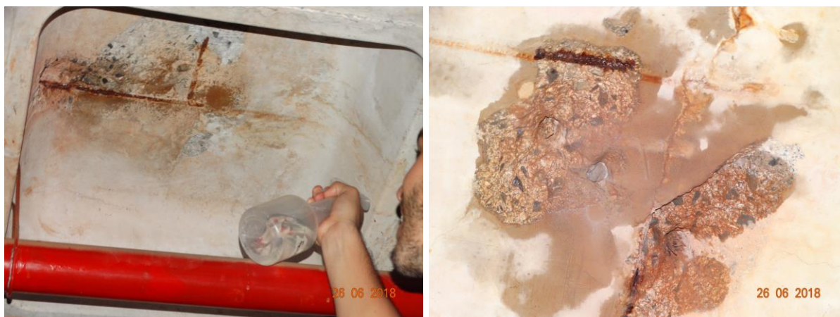
Figura 68 – Comprovação de carbonatação do concreto e visualização de corrosão nas barras de aço da laje de concreto armado em estudo
