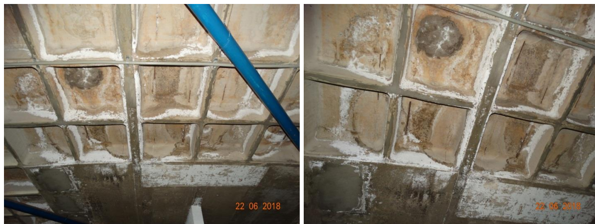
Figura 61 – Sinais de infiltração na laje nervurada do subsolo
