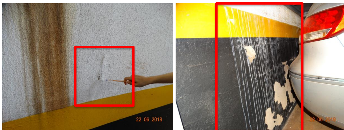
Figura 64 – Sinais de estufamento e deslocamento da pintura na cortina de contenção localizada na vaga 505 (identificação do condomínio)
