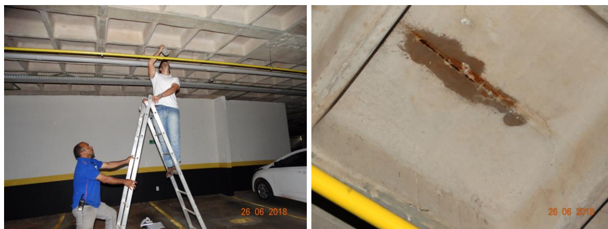
Figura 55 – Realização da aplicação 1 de fenolftaleína na laje nervurada acima da vaga 609 (identificação do condomínio)
