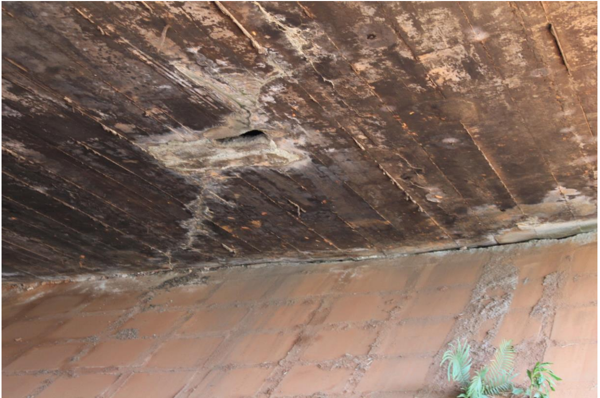
FIGURA 22 – Danos na parte inferior da laje
