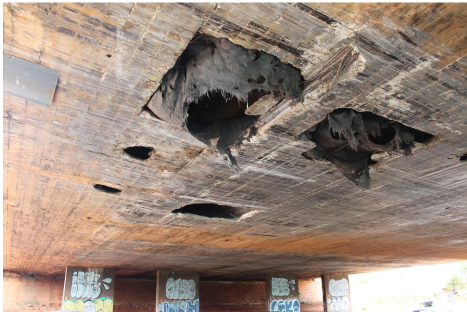
FIGURA 13 – Danos causados por acidentes
