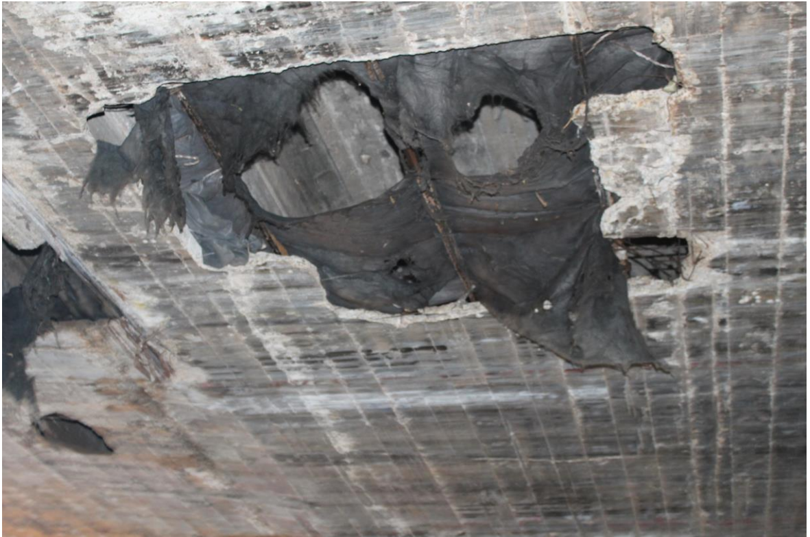
FIGURA 21 – Danos na parte inferior da laje
