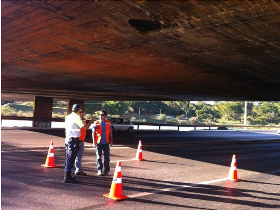
FIGURA 15 – Técnicos da Defesa Civil vistoriam buraco aberto sob a laje da Ponte do Bragueto
