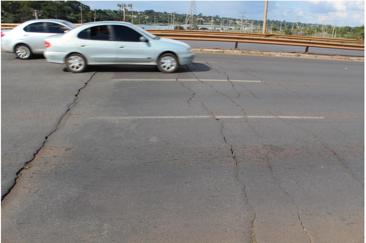
FIGURA 23 – Fissuras no pavimento
