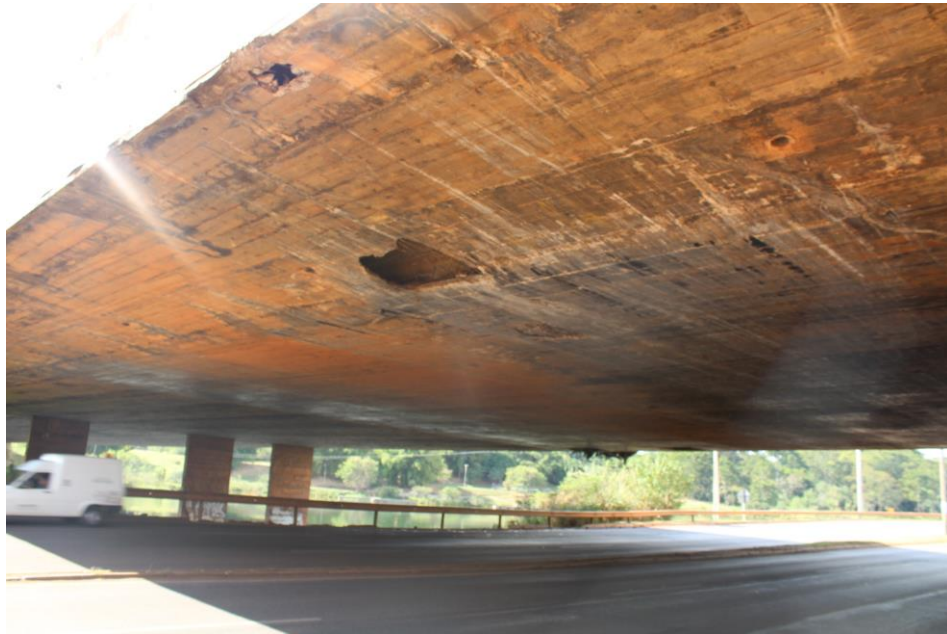
FIGURA 14 – Danos causados por acidentes
