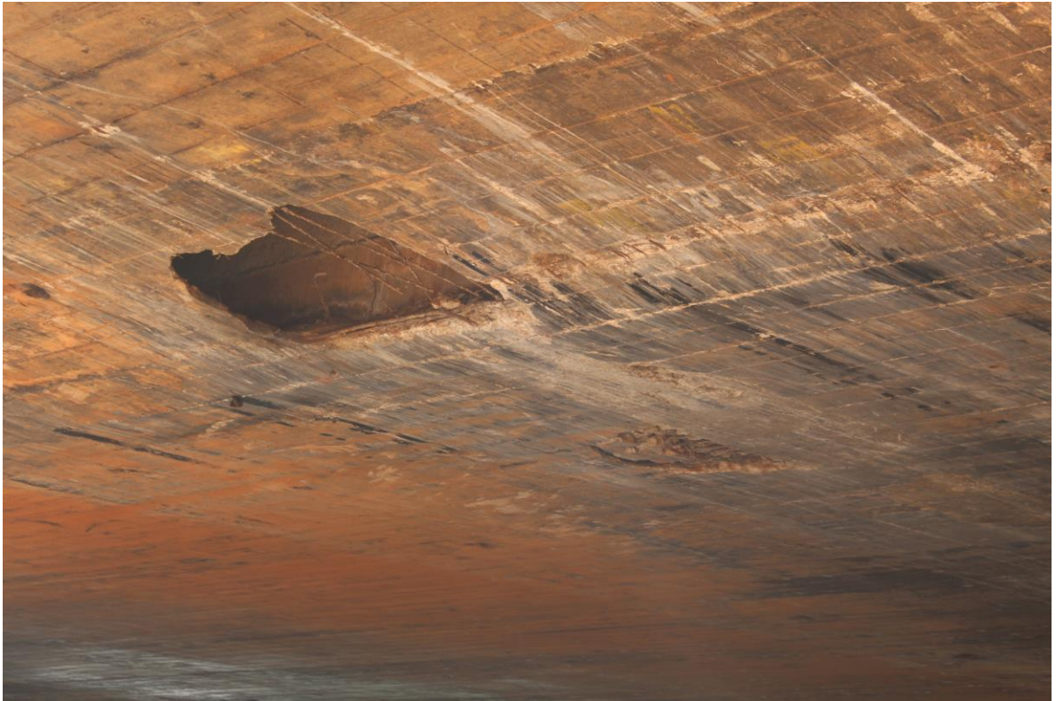
FIGURA 20 – Dano na parte inferior da laje
