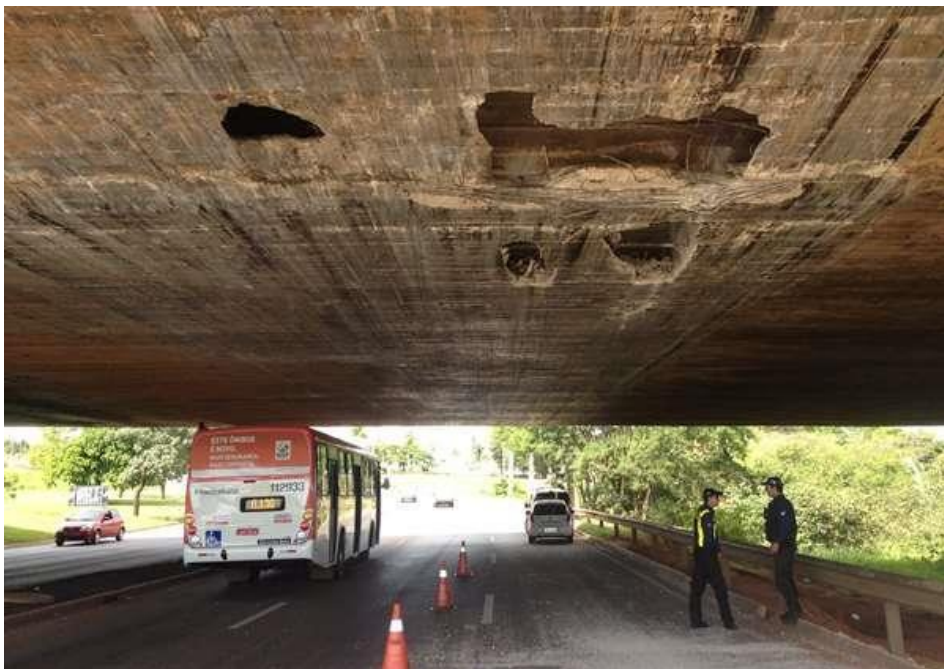
FIGURA 16 – Blocos de concreto caem da Ponte do Bragueto
