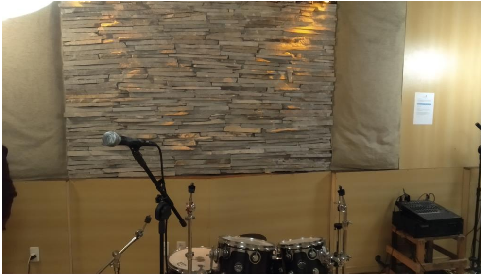
Figura 8– Parede com um difusor de pedras e dois absorvedores de tecido.
