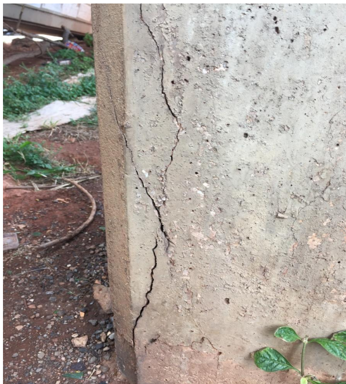
Figura 23 - Fissura paralela a armadura.
