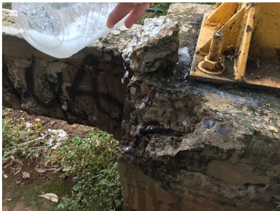
Figura 20 - Aplicação de fenolftaleína, área carbonatada.
