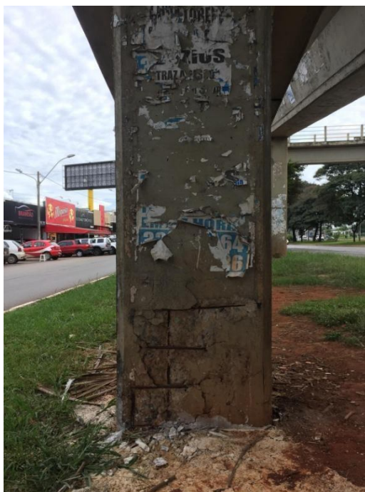
Figura 28 - Pilar em estado de deslocamento do cobrimento.
