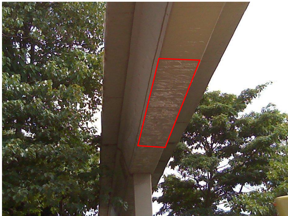
Figura 22 - Eflorescência na base inferior do tabuleiro da passarela.
