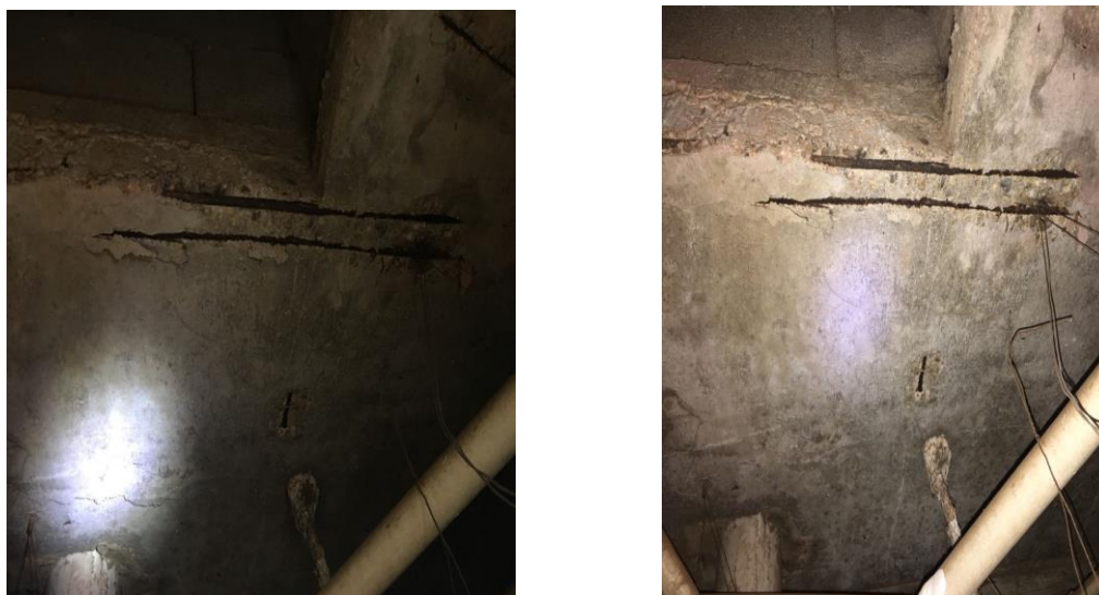
Figura 9: Patologias na Laje do Térreo
