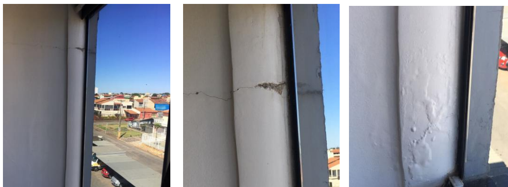
Figura 10: Patologia Pilar em quarto do 3º andar
