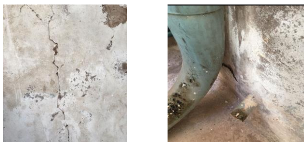
Figura 13: Patologias no poço de acesso à cobertura
