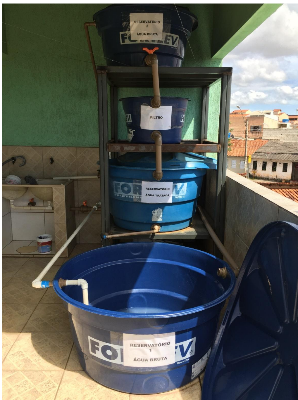
Figura 10 – Vista geral da ETA-piloto
