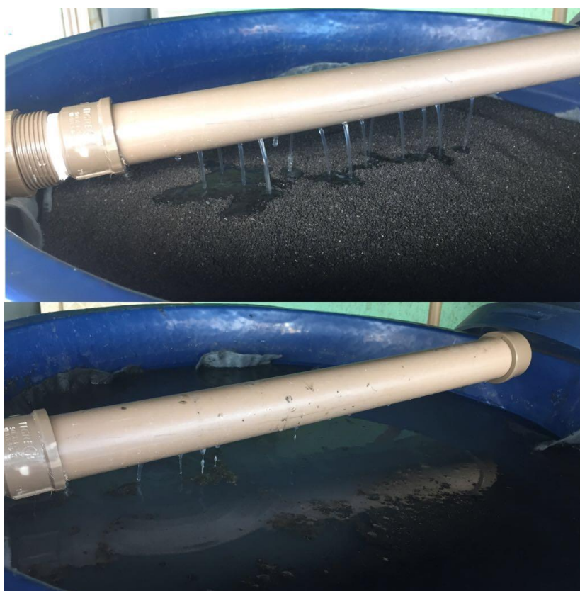
Figura 15 - Filtro com a camada filtrante colmatada
